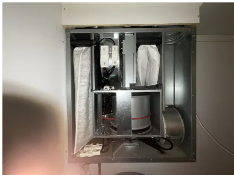
Viser ventilasjonsaggregat innvendig.
