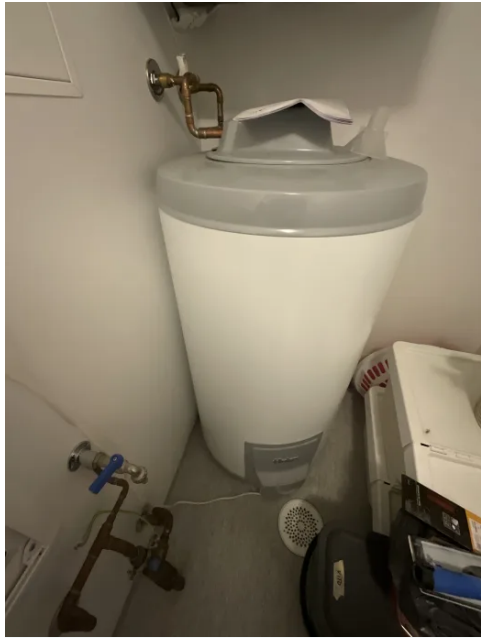
Viser bereder plassert i teknisk rom.
