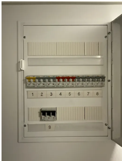
Viser sikringsskap plassert på teknisk rom.
