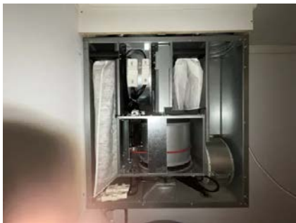
Viser ventilasjonsaggregat innvendig.
