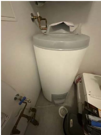
Viser bereder plassert i teknisk rom.
