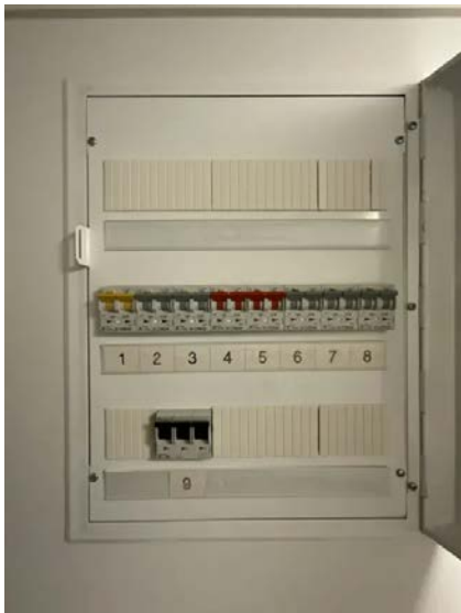
Viser sikringsskap plassert på teknisk rom.
