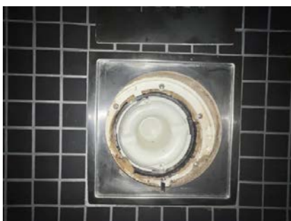
Viser sluk i dusjsonen.
