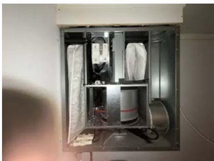
Viser ventilasjonsaggregat innvendig.
