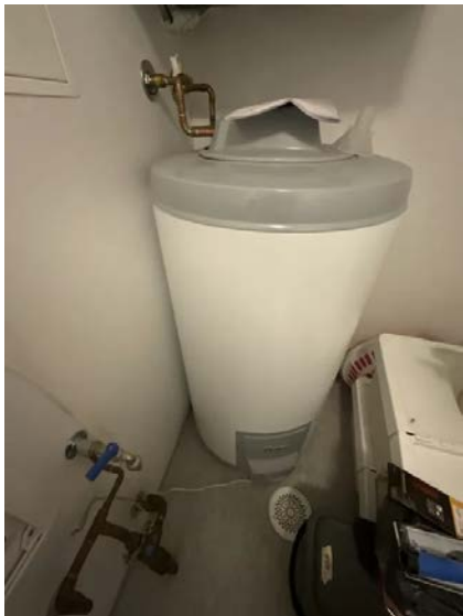
Viser bereder plassert i teknisk rom.
