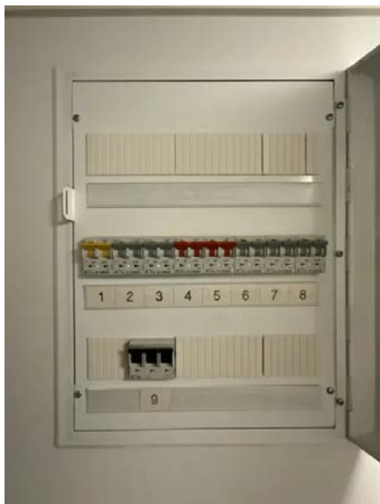
Viser sikringsskap plassert på teknisk rom.
