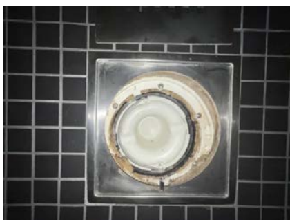
Viser sluk i dusjsonen.
