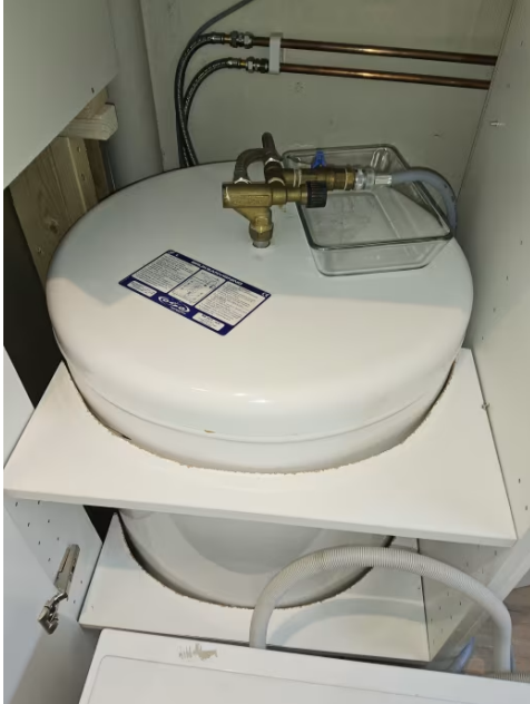
Bilde viser varmtvannsbereder.
