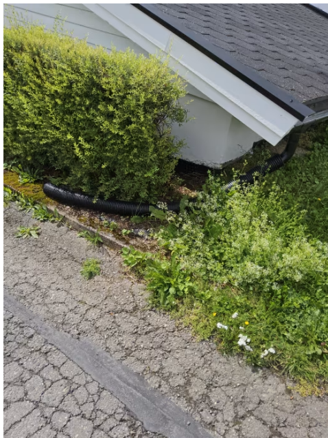
Bilde viser taknedløp avsluttet over bakken.
