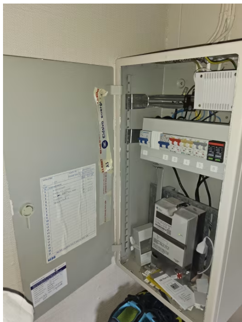
Bilde viser sikringsskap i hybel.
