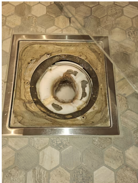
Bilde viser sluk.
