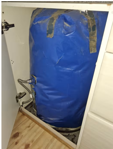
Bilde viser varmtvannsbereder.
