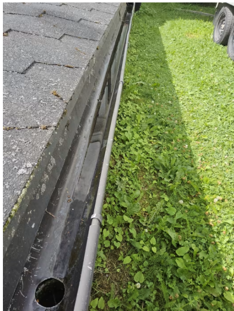
Bilde viser takrenne med motfall.
