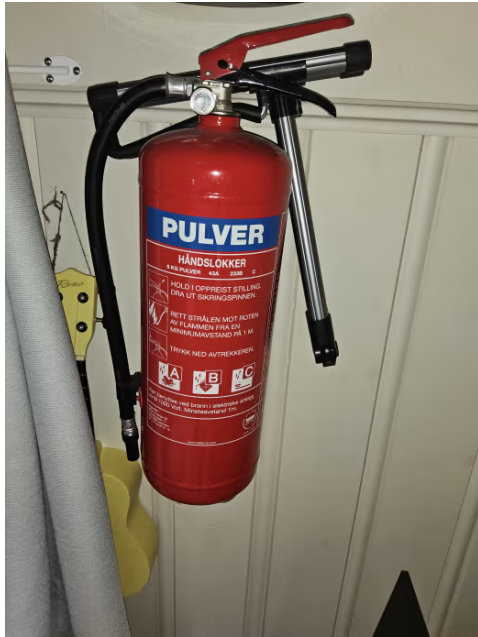
Bilde viser brannslukningsapparat.
