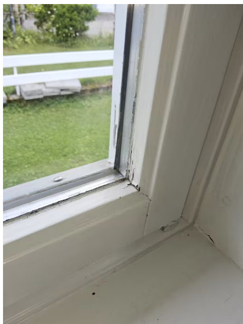
Bilde viser symptom på fuktproblematikk på vindu.
