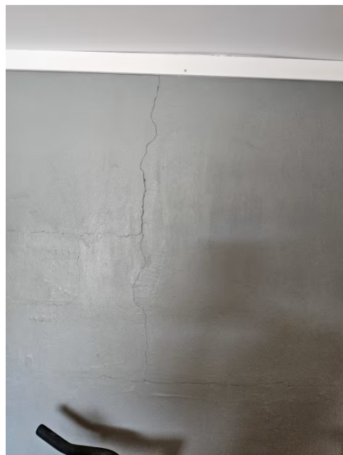
Bilde viser sprekk i grunnmur.
