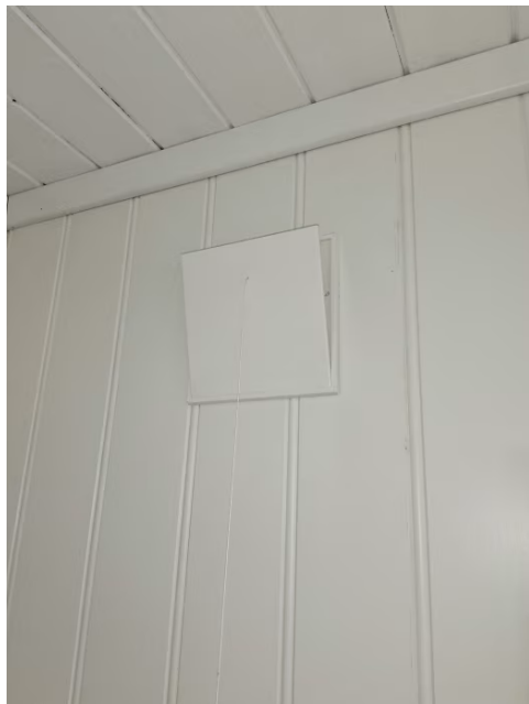
Bilde viser klaffventil på yttervegg.
