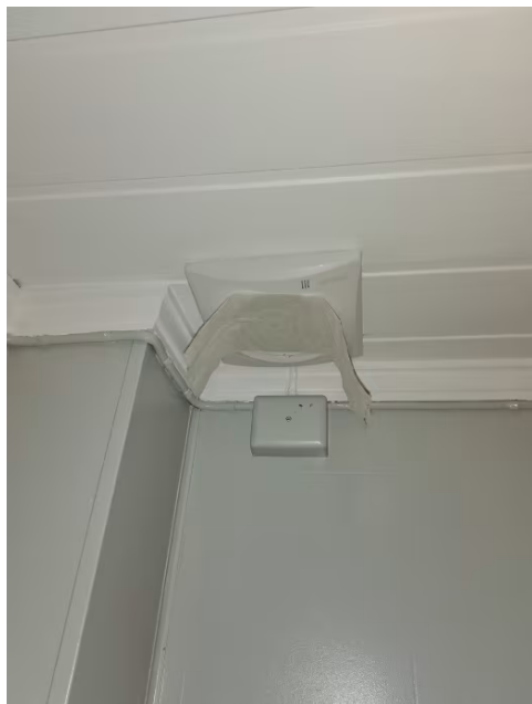
Bilde viser funksjonstest av avtrekk.
