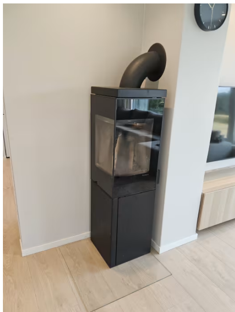
Bilde viser vedovn i 1.etasje.
