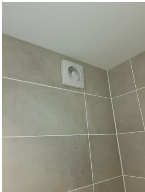
Bilde viser avtrekksvifte.
