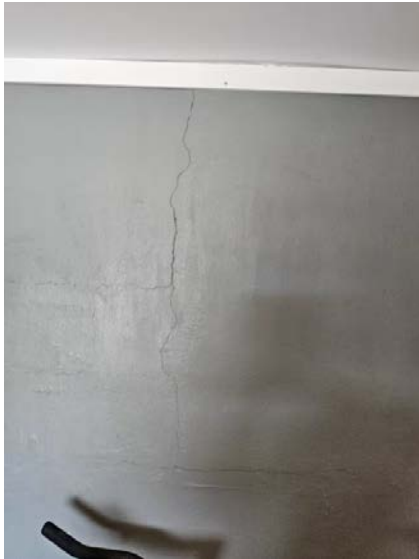
Bilde viser sprekk i grunnmur.
