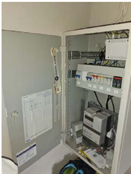
Bilde viser sikringskap i hybel.
