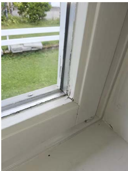
Bilde viser symptom på fuktproblematikk på vindu.
