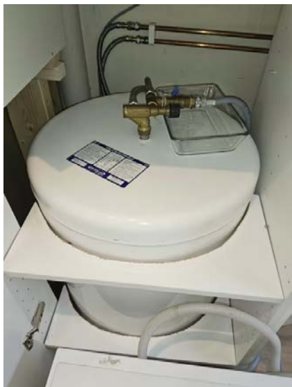
Bilde viser varmtvannsbereder.
