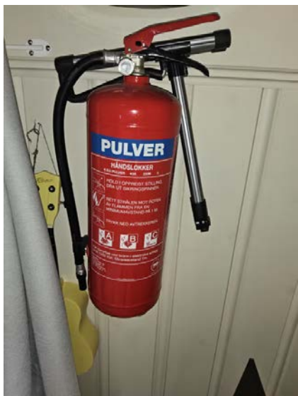
Bilde viser brannslukningsapparat.
