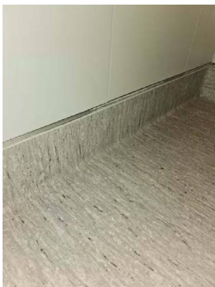
Bilde viser manglende bruk av fugemasse mellom bunnlist og baderomsplater.
