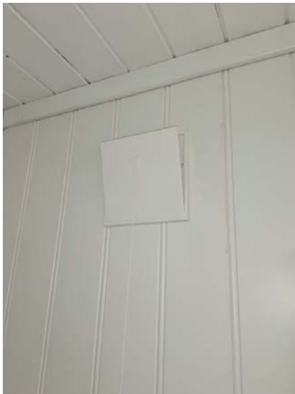
Bilde viser klaffventil på yttervegg.
