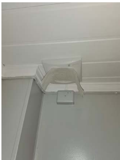
Bilde viser funksjonstest av avtrekk.
