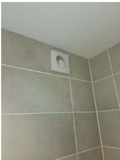
Bilde viser avtrekksvifte.
