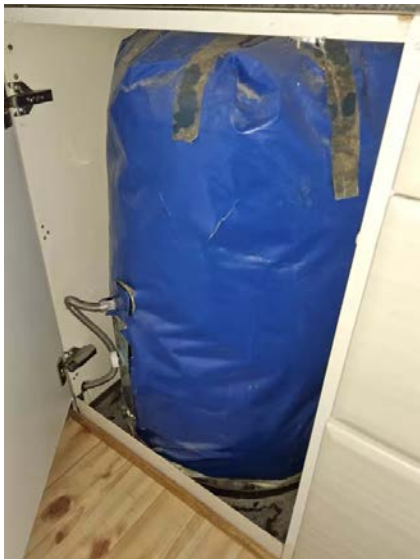
Bilde viser varmtvannsbereder.
