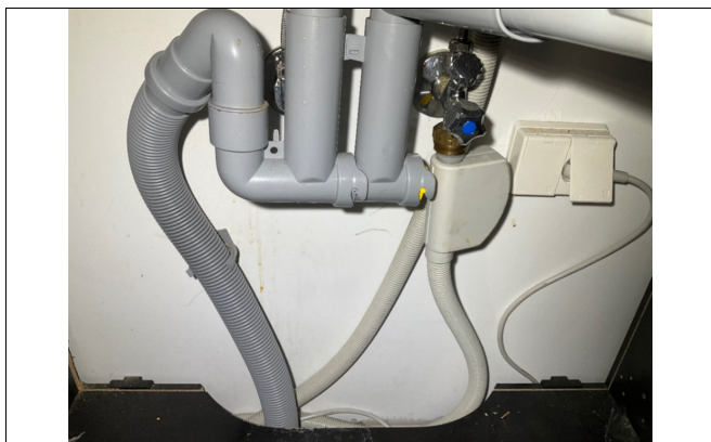
Rørøpplagg i kjøkkenbenk.
