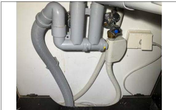
Rørøpplagg i kjøkkenbenk.
