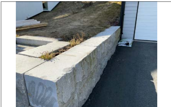
Murkant mangler gjerde, siden den er over 50 cm
