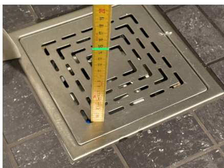
Fallforhold ca. 145 mm topp slukrist i dusjsone
