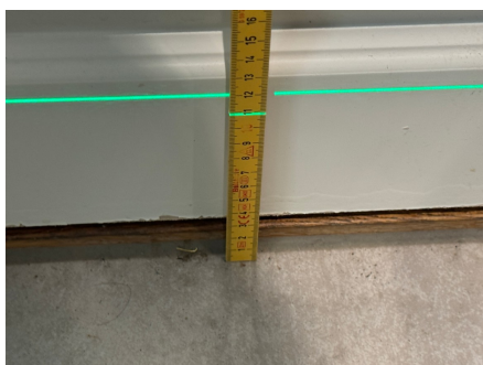
Fallforhold ca. 108 mm overkant gulv ved terskel
