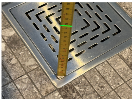
Fallforhold ca. 145 mm topp slukrist i dusjsone
