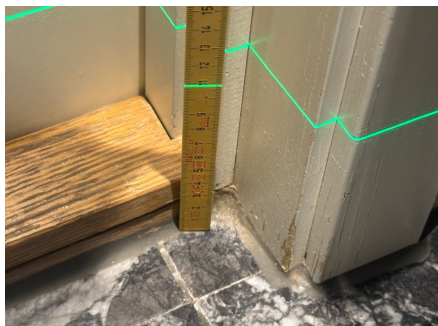
Fallforhold ca. 108 mm overkant gulv ved terskel
