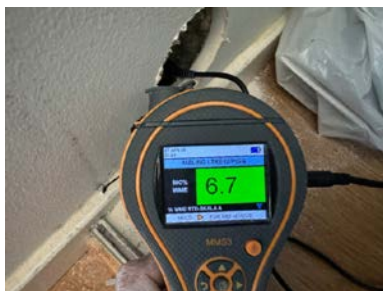
Hulltaking i tilstøtende soverom
