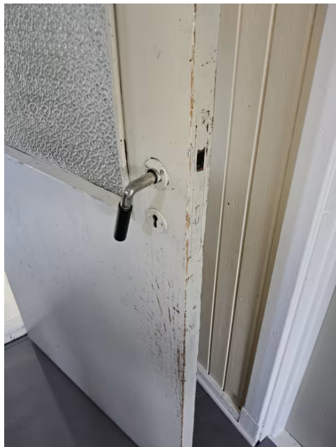
Slitasje på dør og defekt låsekasse.
