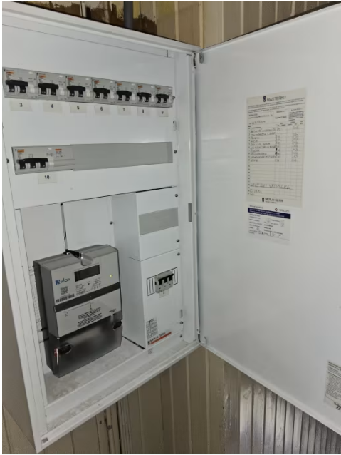
Sikringsskap er plassert i gang i loftsetasje.
