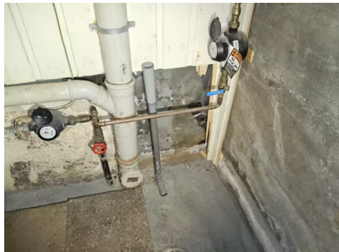
Hovedstoppekran er plassert i kjeller
