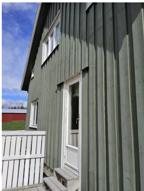
Kledningen er værslitt.
