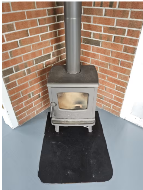
Vedovn med glassdør i stue.
