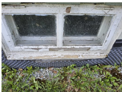
Enkelte varevinduer er sterkt preget av alder/slitasje.
