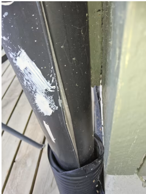
Det registreres buling på enkelte taknedløp.
