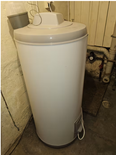
Varmtvannsbereder er plassert i kjeller.
