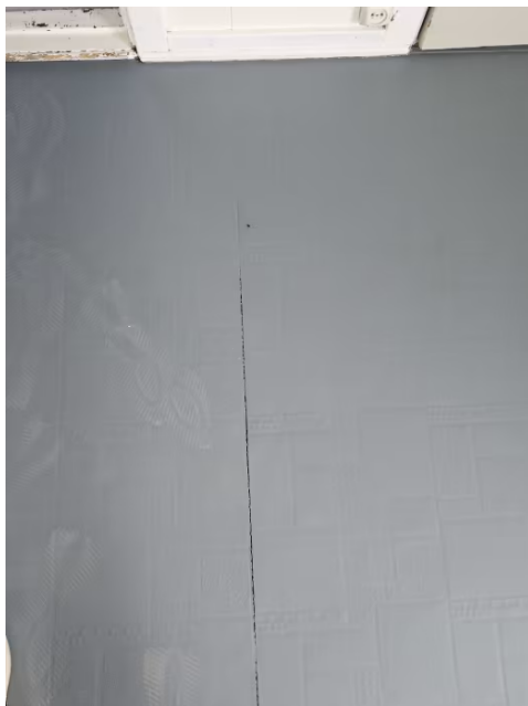
Det registreres sprekker i gulvbelegg.
