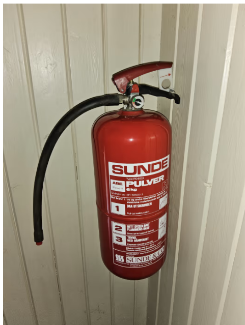
Eldre brannslukningsapparat plassert i gang.
