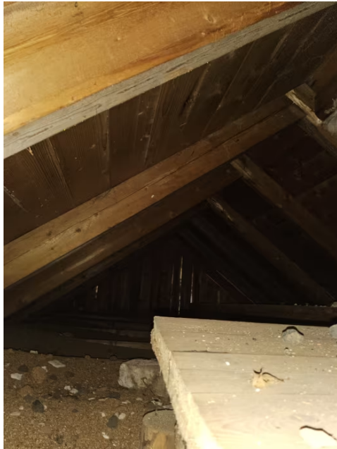
Kaldtloft over deler av boligen.
