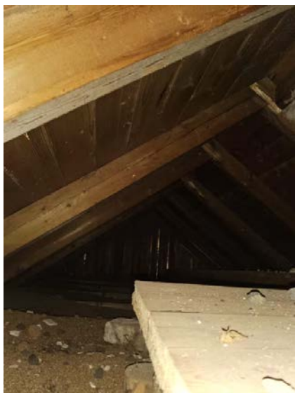
Kaldtloft over deler av boligen.
