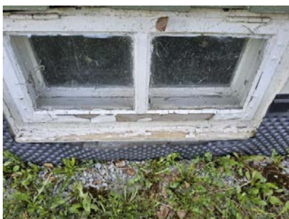
Enkelte varevinduer er sterkt preget av alder/slitasje.
