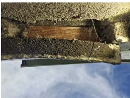
Begrenset lufting bak trekledningen.
