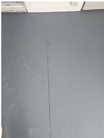
Det registreres sprekker i gulvbelegg.
