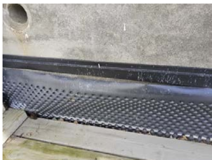
Knotteplast har løsnet fra topplist.
