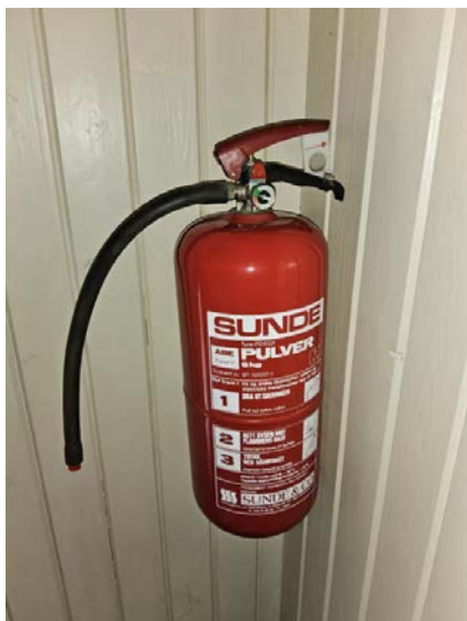
Eldre brannslukningsapparat plassert i gang.
