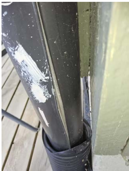
Det registreres buling på enkelte taknedløp.
