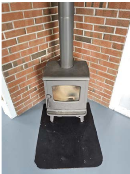
Vedovn med glassdør i stue.
