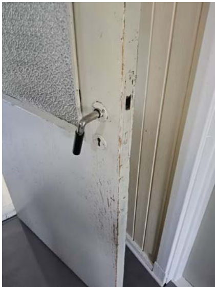
Slitasje på dør og defekt låsekasse.
