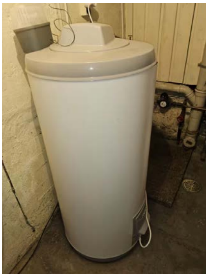
Varmtvannsbereder er plassert i kjeller.
