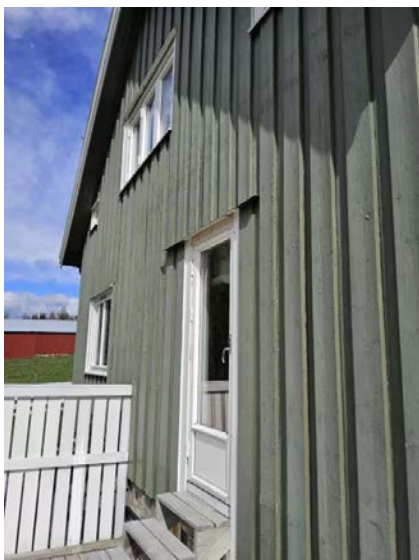
Kledningen er værslitt.
