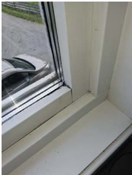
Det registreres symptomer forenelig med kondens på enkelte vinduer.
