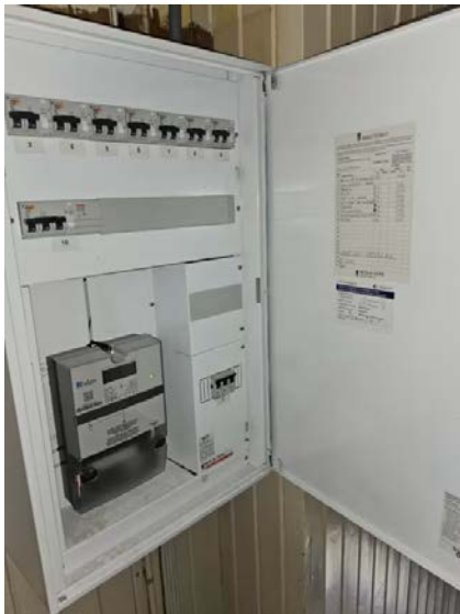
Sikringsskap er plassert i gang i loftsetasje.
