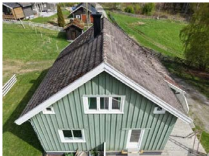
Det er ikke etablert snøfanger på taket.
