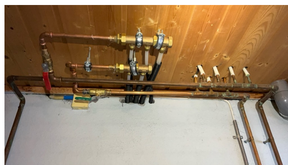
Vannfordelere i vaskerom.
