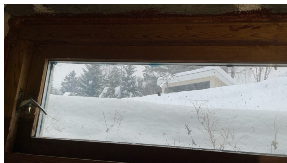
Sprukket vindu vaskerom.
