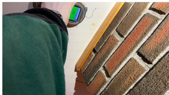
Fuktmerker i himling rundt pipe. Fuktsøk viste normale verdier.
