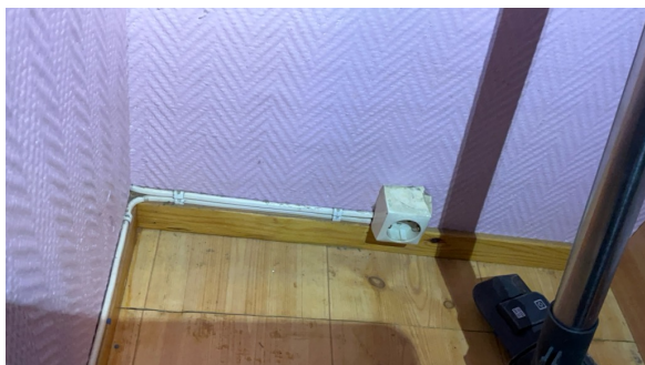
Sprukket stikkontakt på kjøkken.
