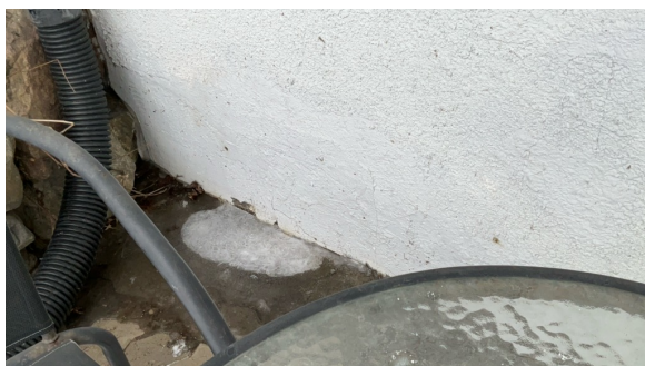
Avskalling og rissdannelser i puss.
