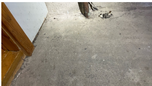
Sprekker og riss i betonggulv.
