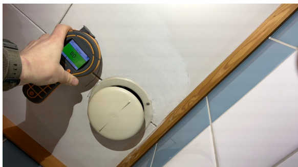
Fuktmerker rundt ventil bad 1. etasje. Fuktsøk viste normale verdier.
