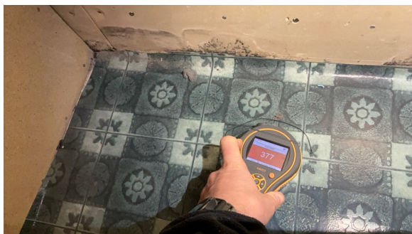
Fuktkrøker flere steder. Fuktsøk viste forhøyde verdier.
