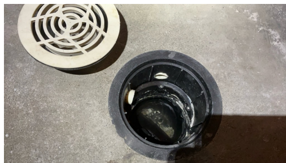
Kontroll av sluk. Det er ikke membran på våtrommet.
