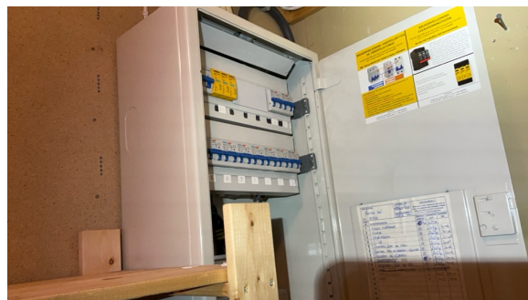
Sikringsskap plassert i bod.
