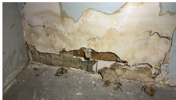
Fuktskader flere steder. Forholdet gis tilstandsgrad 3.
