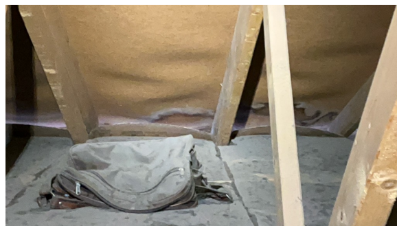
Misfarging og fuktmerker på undertak ved raft.
