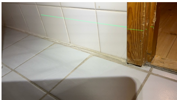
Sprukket flis. Sprekker i fuge i overgang gulv/vegg.
