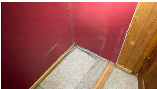
Løse ledninger registrert.
