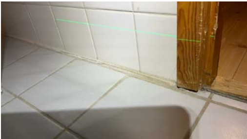
Spruukket flis. Sprekker i fuge i overgang gulv/vegg.
