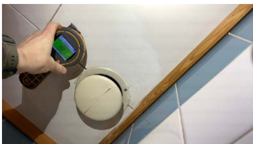
Fuktmerker rundt ventil bad 1. etasje. Fuktsøk viste normale verdier.
