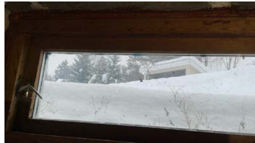
Sprukket vindu vaskerom.
