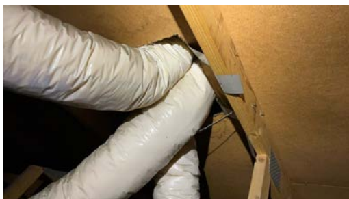
Utett undertak, enkelte fuktmerker rundt gjennomføringer. Fuktsøk viste normale verdier.
