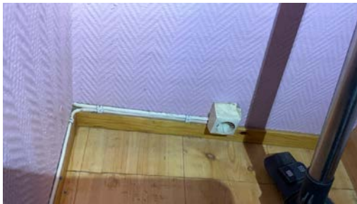
Sprukket stikkontakt på kjøkken.
