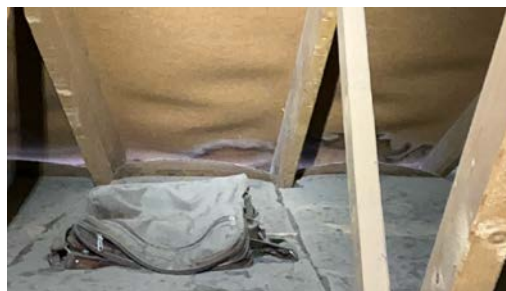
Misfarging og fuktmerker på undertak ved raft.
