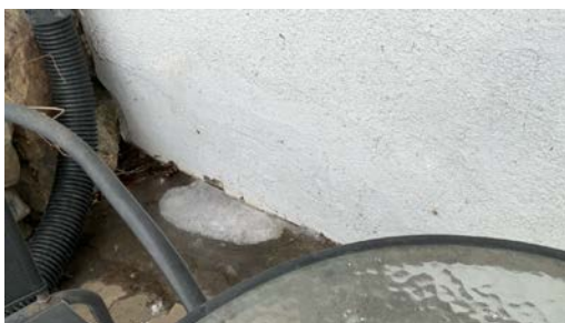
Avskalling og rissdannelser i puss.
