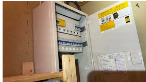
Sikringsskap plassert i bod.
