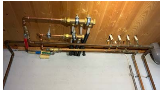
Vannfordelere i vaskerom.
