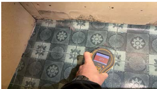
Fuktkerker flere steder. Fuktsøk viste forhøyde verdier.
