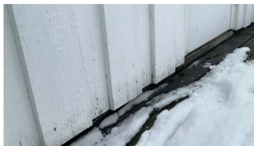
Værslitt kledning enkelte steder.
