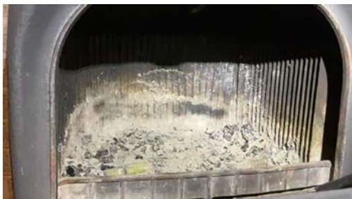
Sprekker i ildfast stein inni ildstedet.
