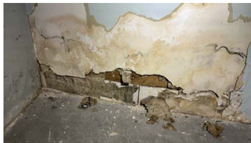
Fuktskader flere steder. Forholdet gis tilstandsgrad 3.
