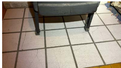
Sprukne fliser rundt ildstedet.
