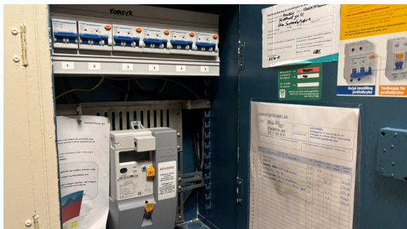
Sikringsskapet er plassert i fellesgangen
