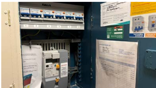
Sikringsskapet er plassert i fellesgangen
