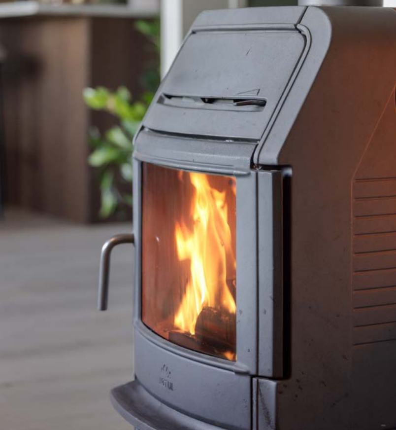
I stua er det montert vedovn. I trappegangen er det montert varmepumpe.
