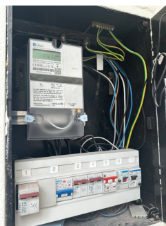
Sikringsskap med automatsikringer.
