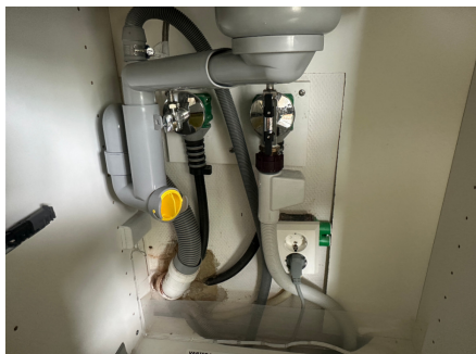
Rørøpplagg i kjøkkenbenk med Waterguard
