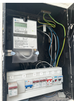
Sikringsskap med automatsikringer.
