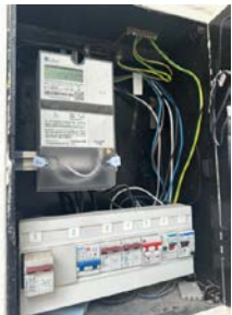
Sikringsskap med automatsikringer.
