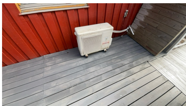
Varmepumpe er defekt.
