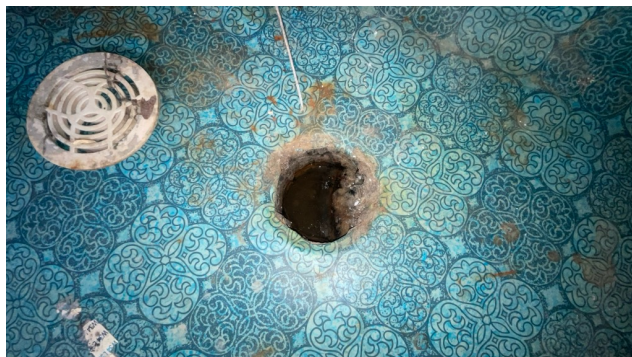
Utett overgang i sluk.
