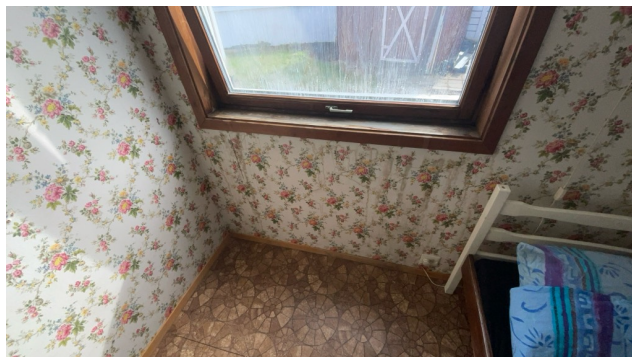
Skade på vegg i soverom 1 etg.
