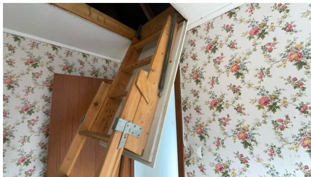
Loftluke er ikke isolert og mangler pakning.
