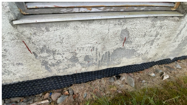
Riss/sprekker i utvendig puss
