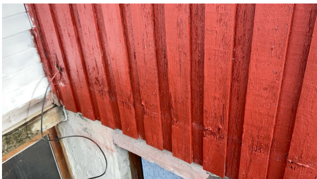
Råteskader i kledning
