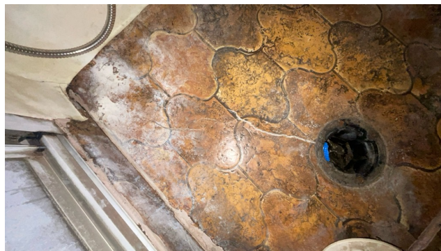
Sprekker i belegg i dusj.
