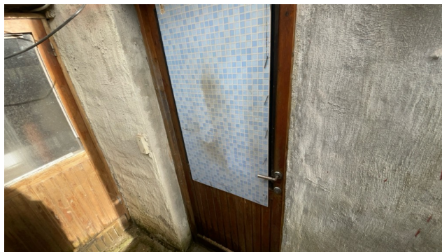
Knust glass i kjellerdør
