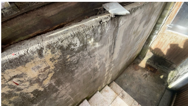
Riss/sprekke i vange for kjellertrapp.
