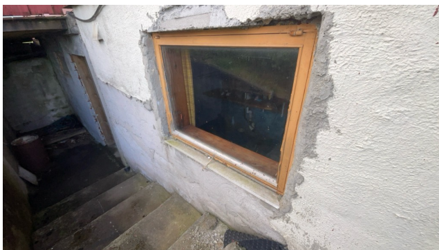
Det er påvist vinduer med fukt/råteskader.
