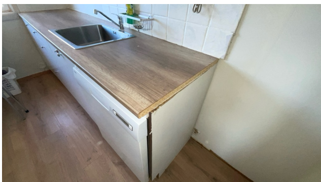
Laminat mangler i ender på benkeplate
