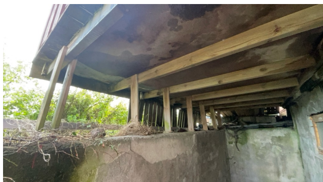
Terrasse mot nord er mangelfullt understøttet.
