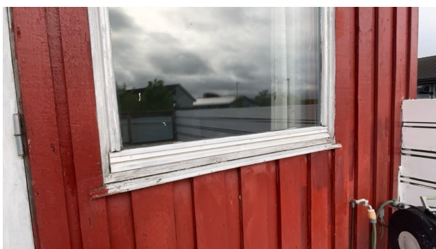
Det er påvist vinduer med fukt/råteskader.
