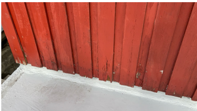
Råteskader i kledning
