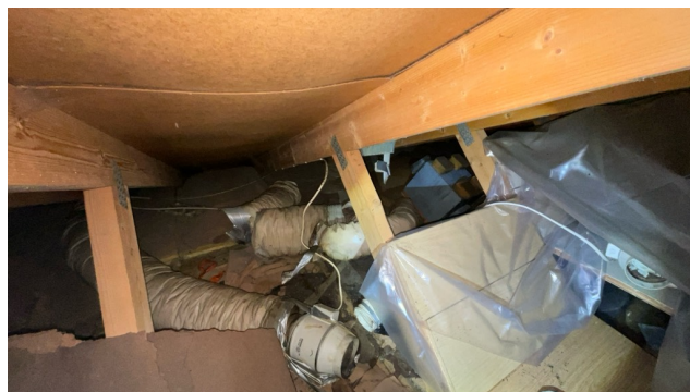
Mekanisk avtrekk er frakoblet og ikke i funksjon.
