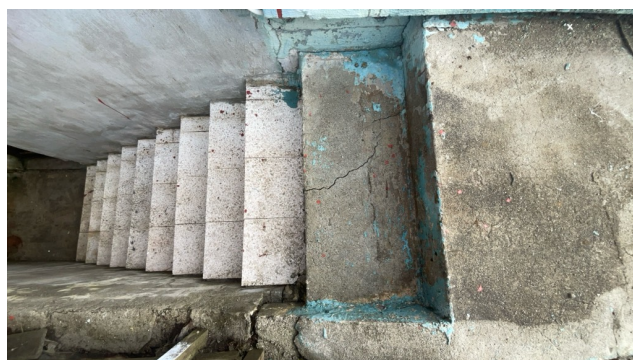
Sprekker i trinn.
