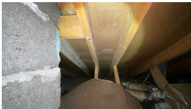
Skade/hull i sutaksplate.
