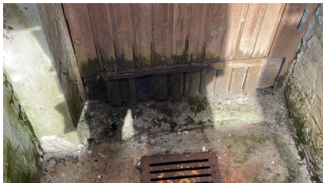
Råteskade i dør
