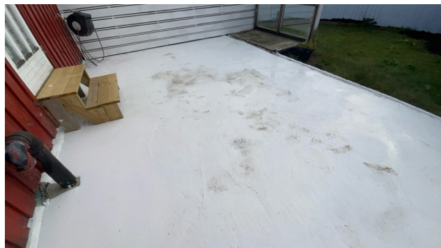
Mangelfullt fall på terrasse
