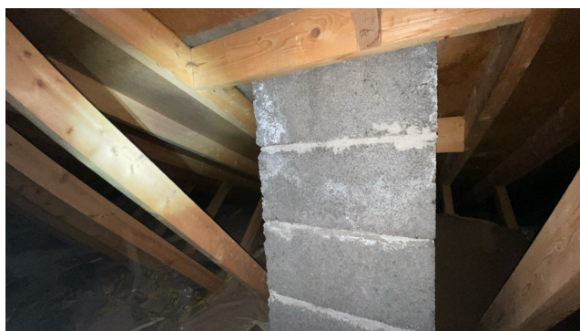
Saltutslag på pipe loft
