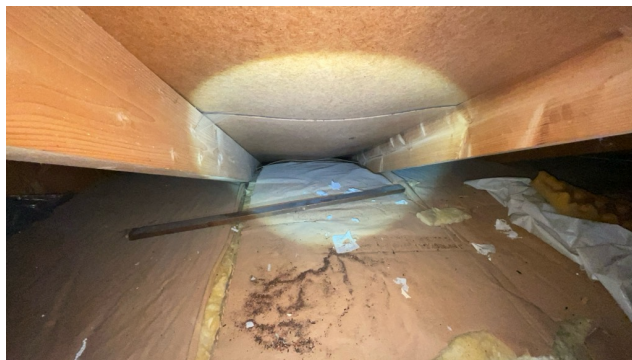
Det er begrenset/dårlig ventilering av takkonstruksjonen.
