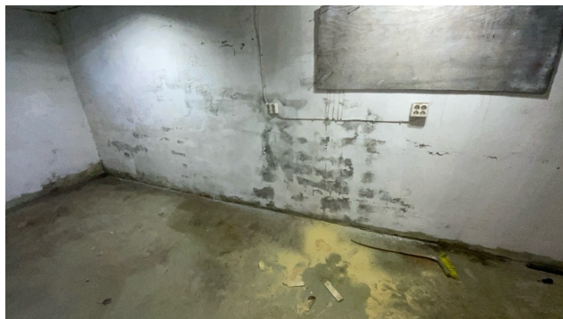
Registrert saltutslag innvendig på grunnmur der den er synlig i flere rom.
