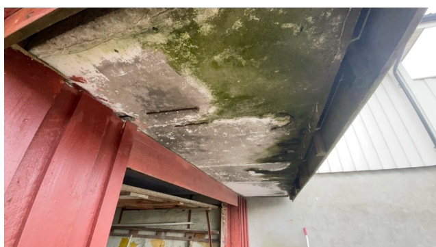
Avskalling av betong og korrosjon i armering.
