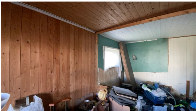
Skade på vegg i lagerrom
