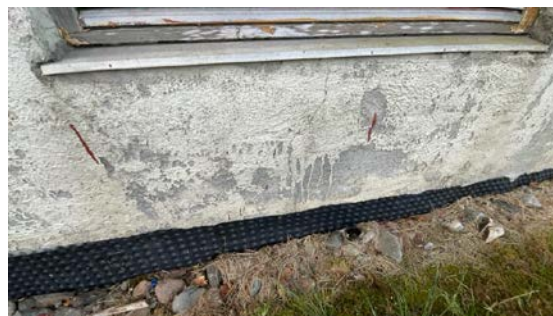
Riss/sprekker i utvendig puss
