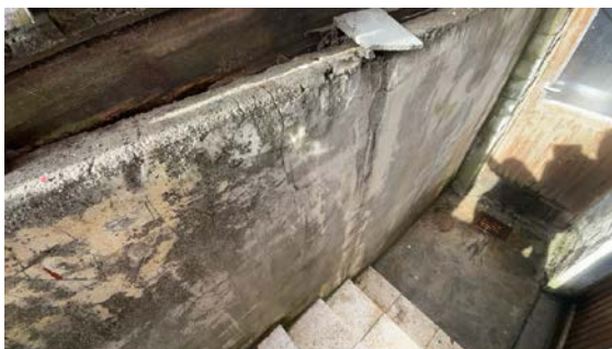
Riss/sprekk i vange for kjellertrapp.
