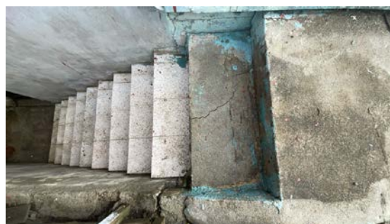
Sprekker i trinn.
