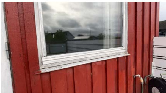
Det er påvist vinduer med fukt/råteskader.
