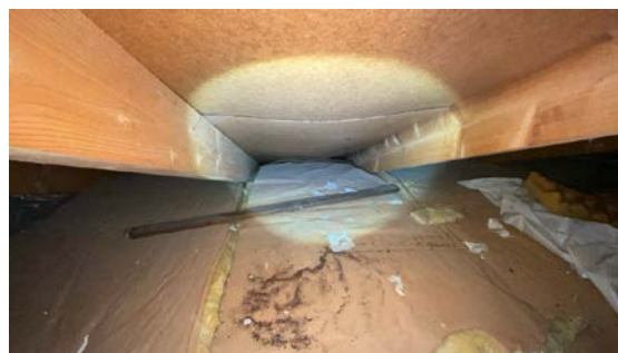
Det er begrenset/dårlig ventilering av takkonstruksjonen.
