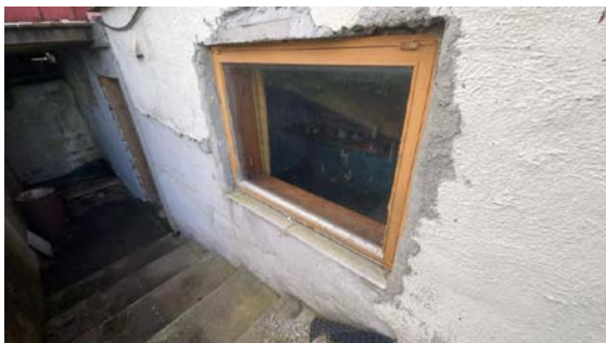
Det er påvist vinduer med fukt/råteskader.
