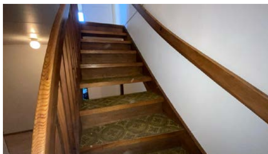
Plater i enkelte opptrinn mangler.
