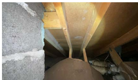
Skade/hull i sutaksplate.
