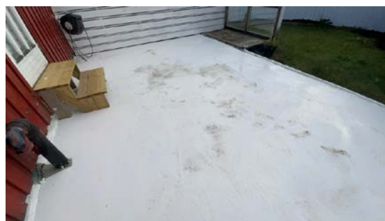
Mangelfullt fall på terrasse
