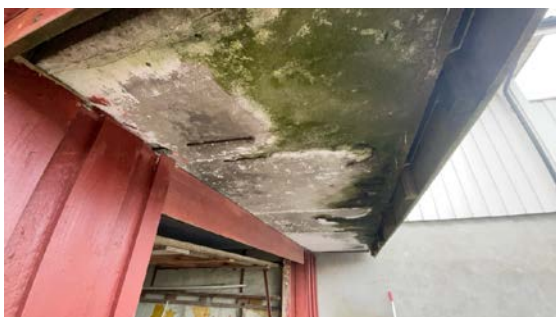
Avskalling av betong og korrosjon i armering.
