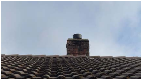
Registrert løse fuger og enkel murstein på pipetopp.
