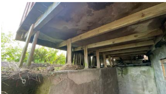
Terrasse mot nord er mangelfullt understøttet.
