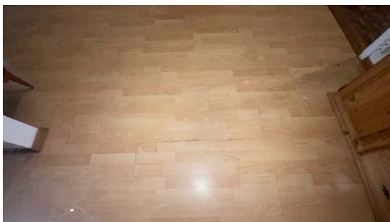
Skader i gulv generelt.
