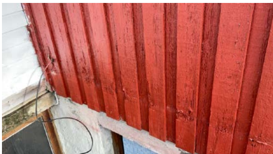
Råteskader i kledning
