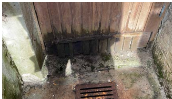
Råteskade i dør
