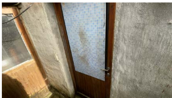
Knust glass i kjellerdør
