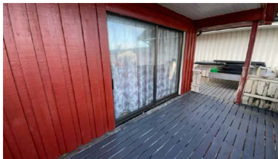
Skyvedør er stri å åpne/lukke samt lås er defekt.
