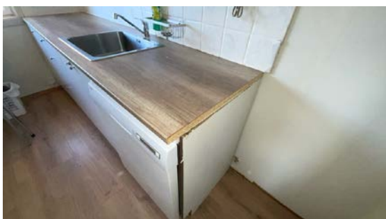
Laminat mangler i ender på benkeplate
