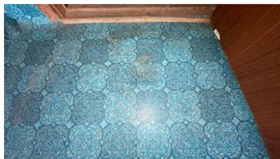
Belegg er lagt over utsparing i gulv foran dør. Ukjent hva som er under.
