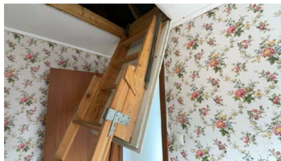
Lofluka er ikke isolert og mangler pakning.
