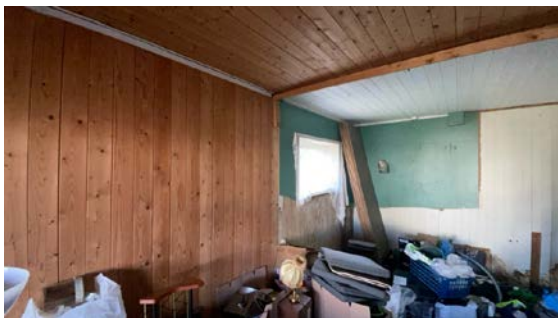
Skade på vegg i lagerrom
