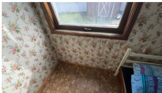
Skade på vegg i soverom 1 etg.
