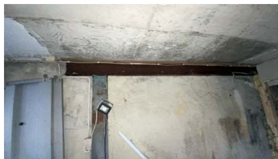
Korrosjon i jernbjelke og søyle i garasje samt i jernbjelke over port.
