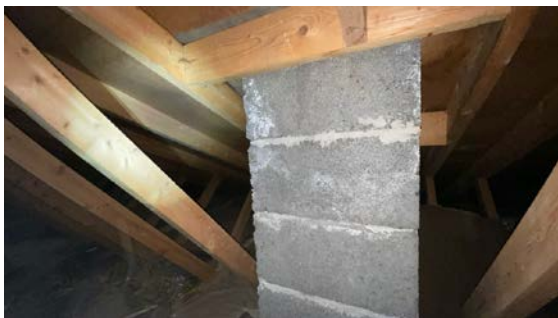
Saltutslag på pipe loft
