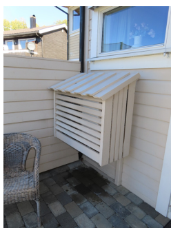
Luft til luft varmepumpe fra byggeår.
