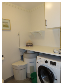
Vanninntak, varmtvannsbereder samt vann og avløpsuttak for vaskemaskin.
