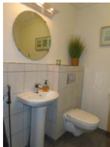
Vaskerom/toalettrom, kombinert rom med tekniske installasjoner.
