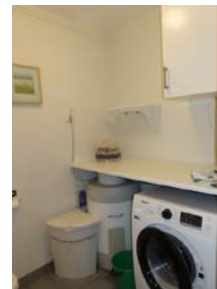
Vanninntak, varmtvannsbereider samt vann og avløpsuttak for vaskemaskin.
