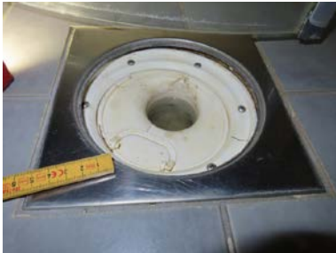
Plastsluk med klemring. Mansjett og membran påvist i sluk.
