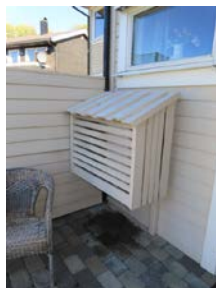
Luft til luft varmepumpe fra byggeår.
