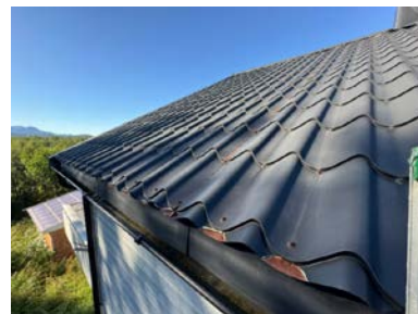
Rustskader på tekkingen
