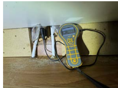
Fuktmåling i tilgjengelig trevirke fra kjøkkenet.
