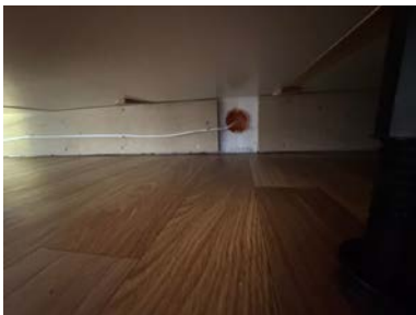
Skadet klips til ledningen.
