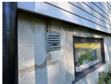
Eksempel på sprekk i grunnmuren.
