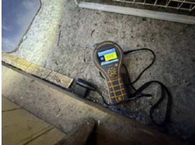
Fuktmåling i trevirke under trappen.
