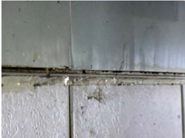
Fuktskader i nedkanten av baderomsplatene.
