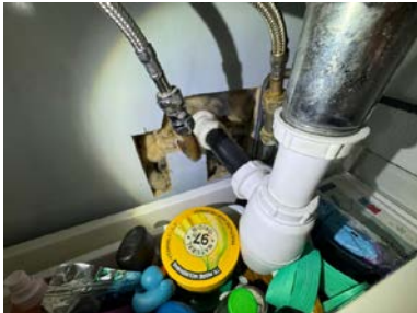
Ikke tilfredsstillende membran under servanten.
