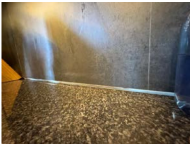
Det er ikke fuget i overgangen mellom benkeplaten og veggen.
