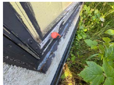
Åpning mellom vindu og veggen.
