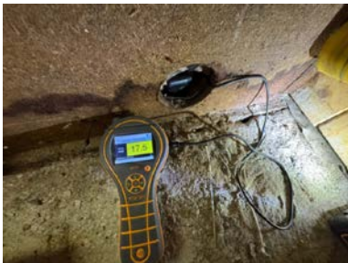
Fuktmåling i utforet vegg.
