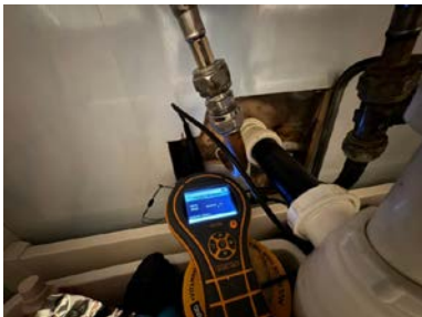
Fuktmåling i tilgjengelig trevirke på badet.
