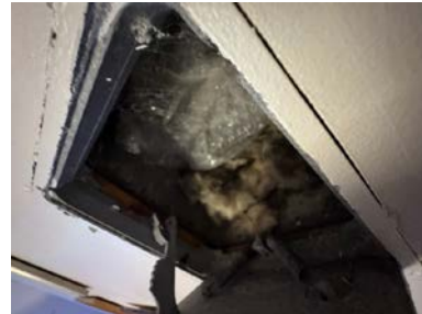
Veggventil som er tettet.
