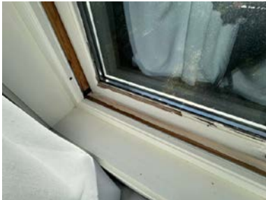
Tegn til ikke tilfredsstillende ventilasjon.
