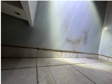
Svertesopp på baderomsplatene bak dusjkabinettet.
