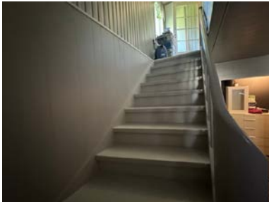
Det er ikke montert håndløper på veggen.
