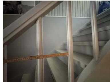
åpninger i rekkverket.
