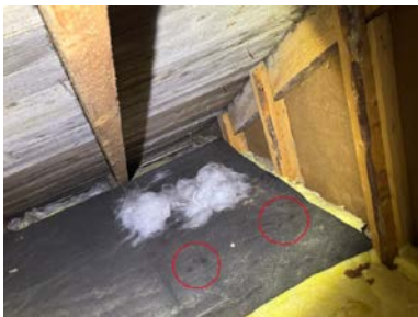
Tegn til at det har vært høy fuktighet på kaldloftet.
