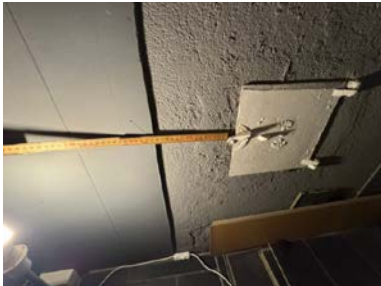
Sotluken er for nært brennbart materiale.
