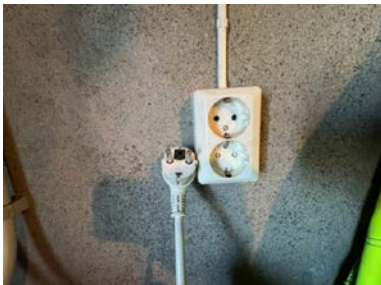
El-tilkobling av varmtvannstank.
