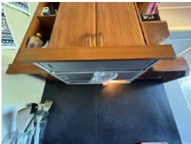
Funksjonstest av ventilatoren.
