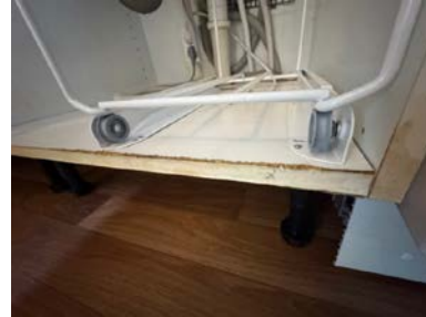
Fuktsvelling i bunnplaten i kjøkkenskapet.
