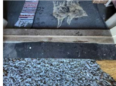
Det er åpning mellom beslaget og døren.
