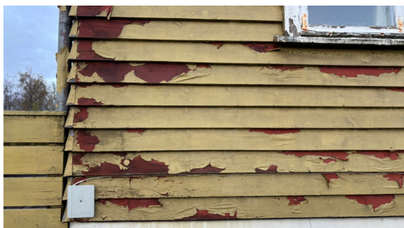
Malingsavskalling på bordkledningen
