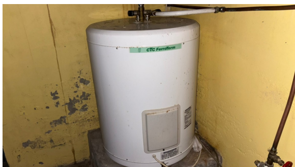
Varmtvannstank i kjelleren
