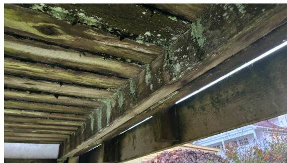
Stedvis råteskader på bjelkelaget
