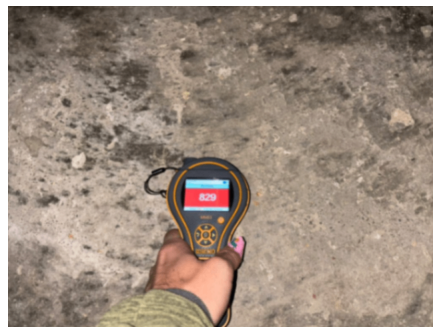
Fuktutslag på yttervegger og gulv
