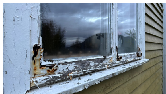
Vinduene er sterkt nedslitt
