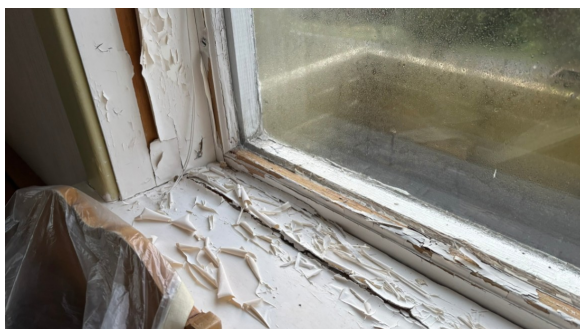
Vinduene er sterkt nedslitt
