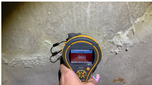
Fuktutslag på yttervegger og gul
