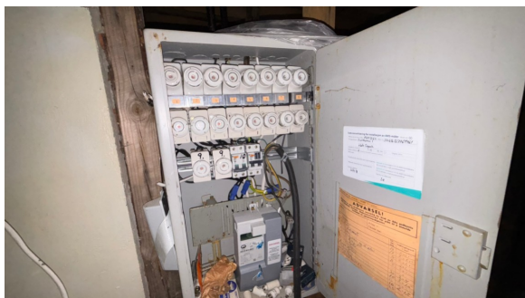
Fordelerskapet står i gangen
