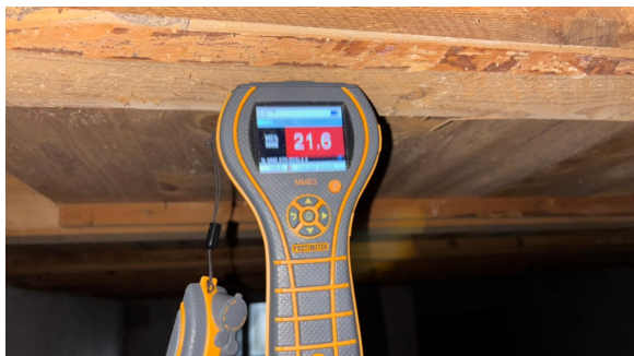
Utslag på fukt i etasjeskille mellom kjeller og 1.etasje
