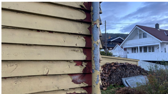
Avskalling av maling på nedløp
