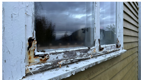
Vinduene er sterkt nedslitt
