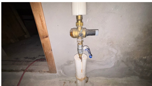
Hovedstoppekranen er plassert i kjelleren
