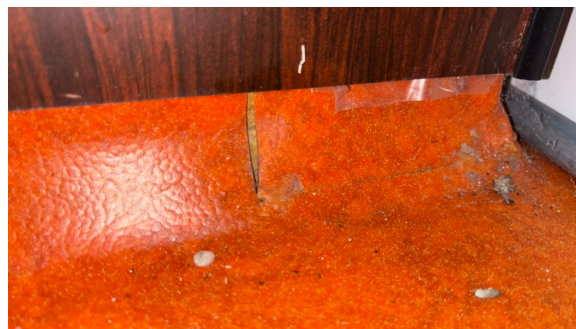
Sprekker i gulvbelegget
