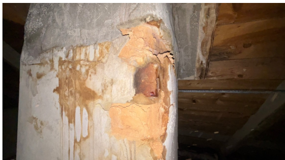
Avskalling av puss på loftet
