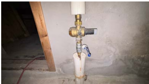
Hovedstoppekranen er plassert i kjelleren
