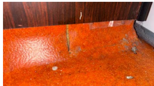
Sprekker i gulvbelegget
