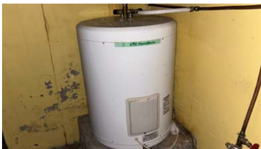
Varmtvannstank i kjelleren
