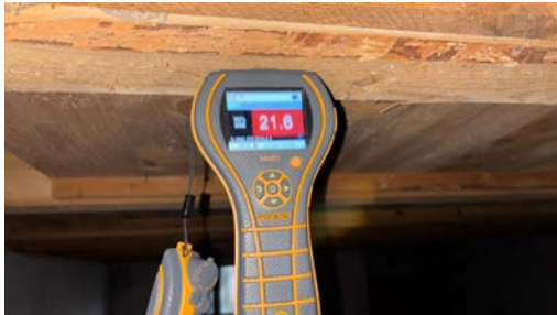
Utslag på fukt i etasjeskille mellom kjeller og 1.etasje
