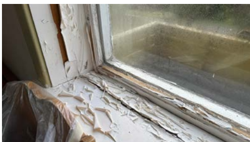
Vinduene er sterkt nedslitt
