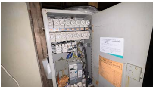
Fordelerskapet står i gangen
