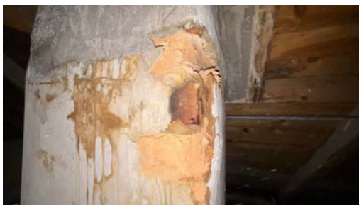
Avskalling av puss på loftet
