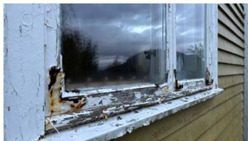
Vinduene er sterkt nedslitt
