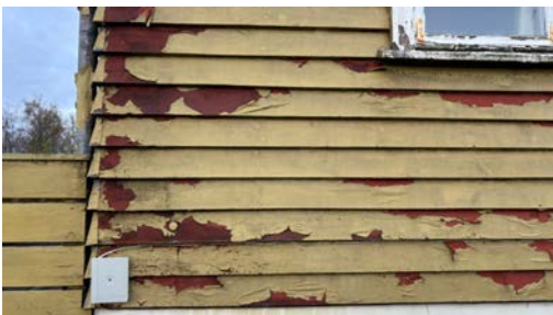
Malingsavskalling på bordkledningen
