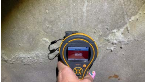
Fuktutslag på yttervegger og gul
