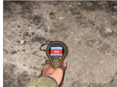
Fuktutslag på yttervegger og gulv
