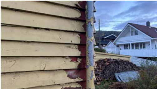
Avskalling av maling på nedløp
