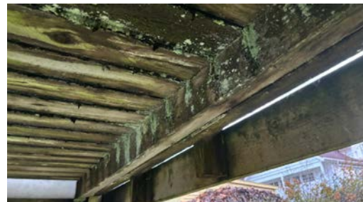
Stedvis råteskader på bjelkelaget
