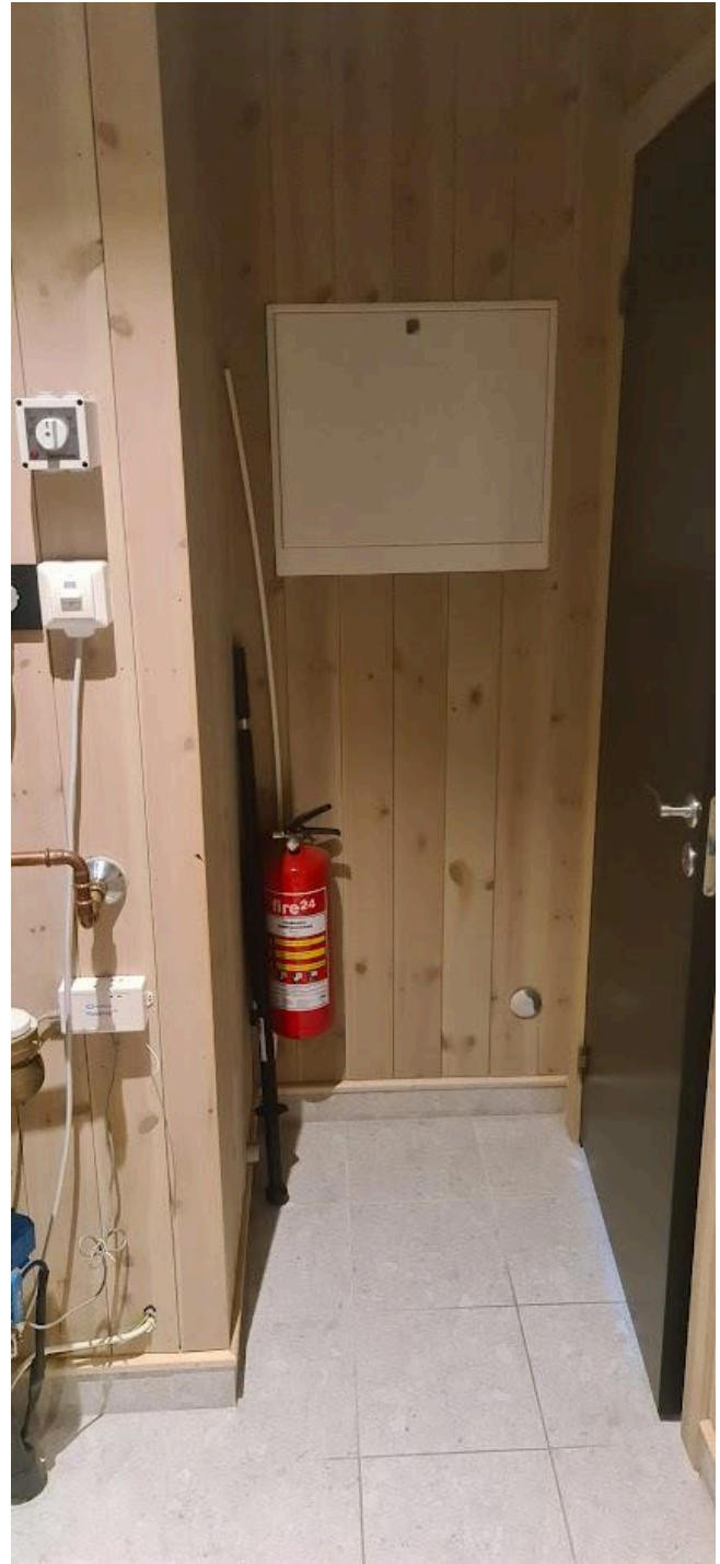
Teknisk rom som viser samleskap for rør i rør system samt brannslukningsapparat.
