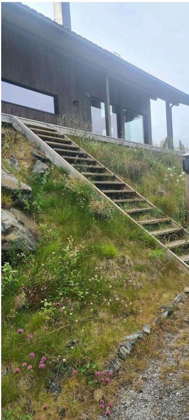
Terreng trapp uten rekkverk.
