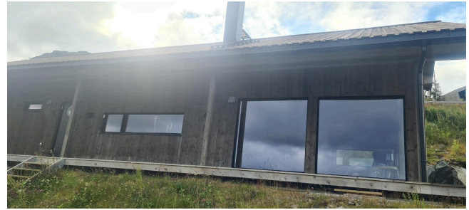
Terrasse på lang vegg med hovedinngang uten rekkverk.
