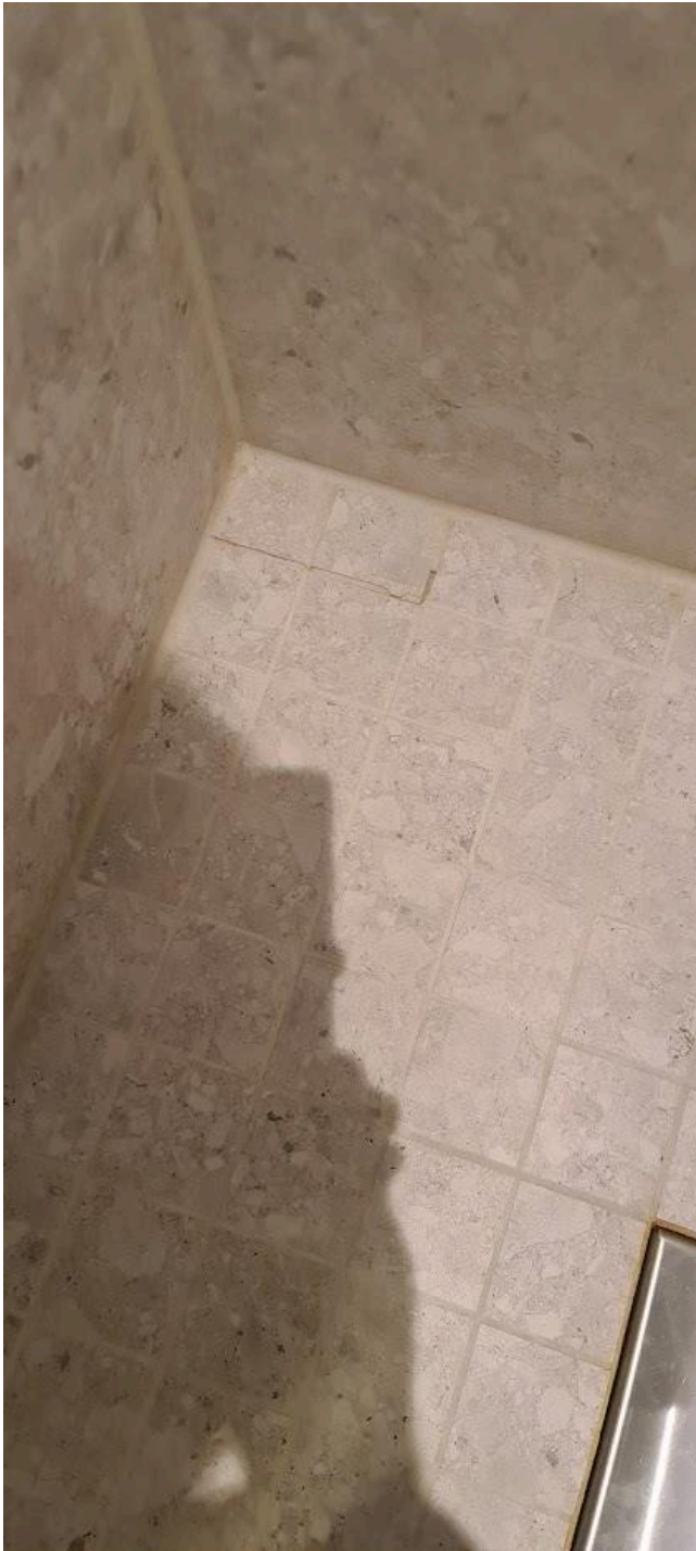
2 fliser er løse i hjørne dusj nisje.
