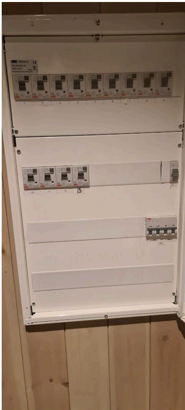
Sikringskap med jordfeil automatsikringer.
