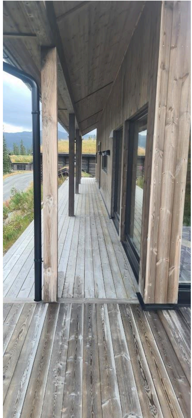
Overbygd terrasse å langvegg/hovedinngang. Terrasse mangler rekkverk.
