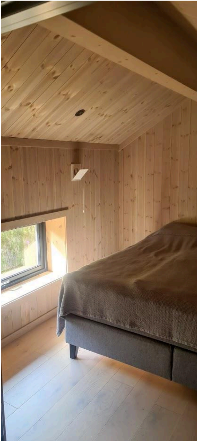
Soverom 2 som viser vindu som ikke er godkjent som rømningsvindu.
