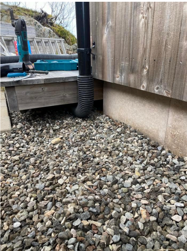
Eier sitt bilde tatt 24.10.24 hvor han har montert avløpsledning fra baksiden av hytta og under terrasse
