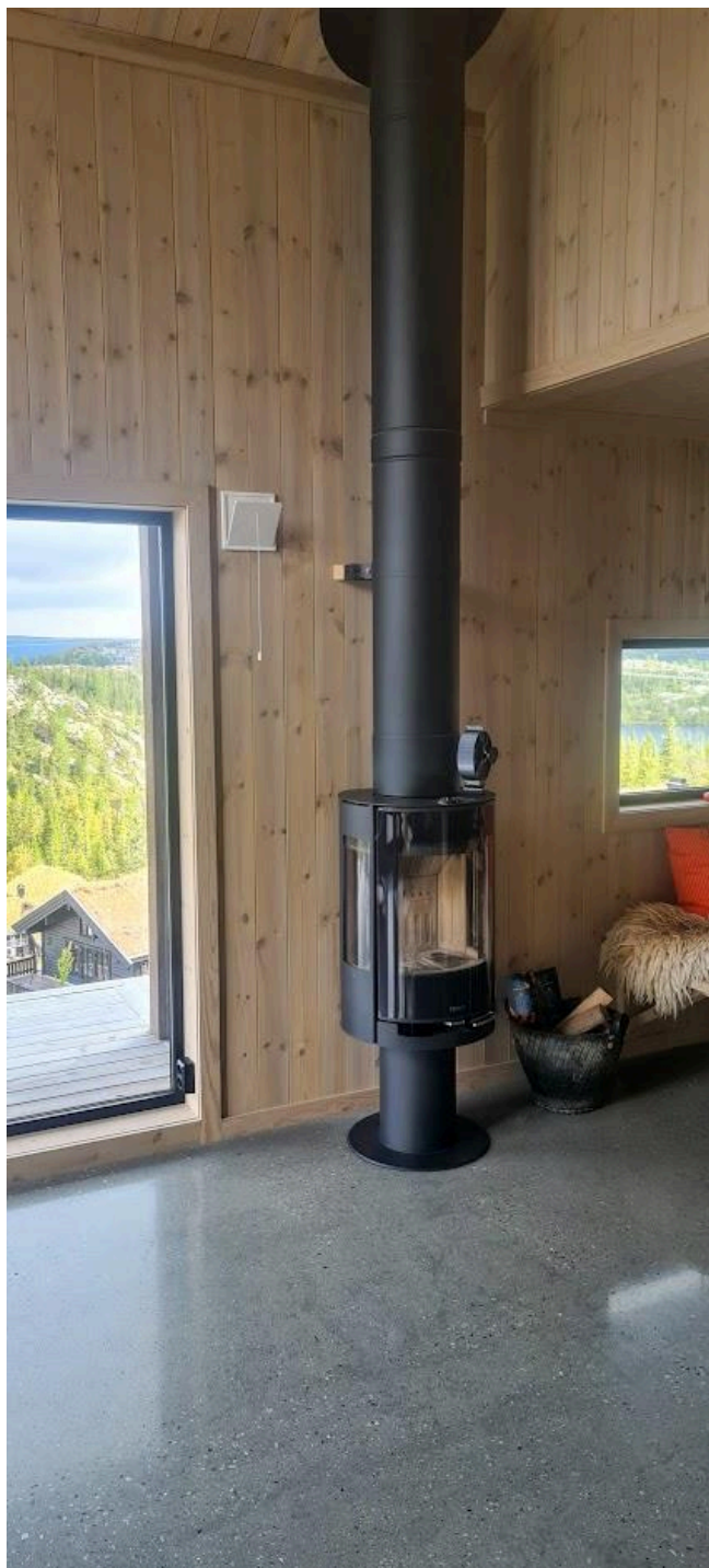
Aduro peisovn hvor Tolmer stålskorstein er monteret ned på topp peisovn.
