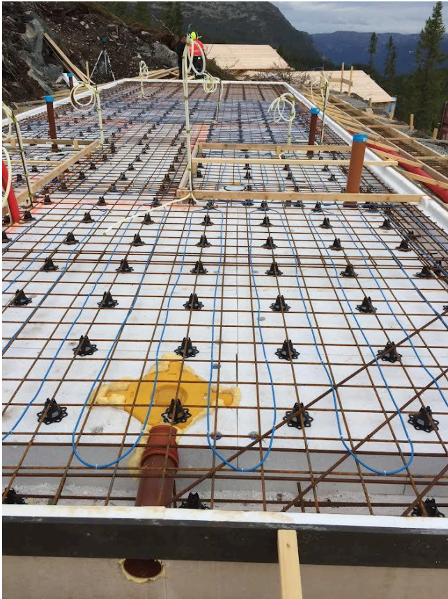
Bilde viser varmekabel i betonggulv i 1.etg.
