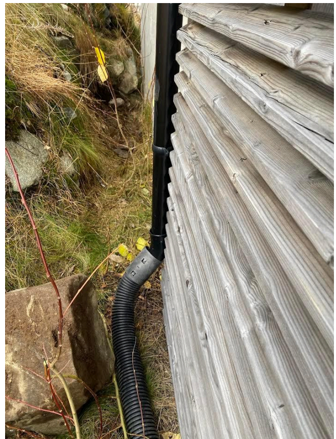
Eier sitt bilde tatt 24.10.24 hvor han montert avløpsledning fra baksiden av bod og ut i terrenget.
