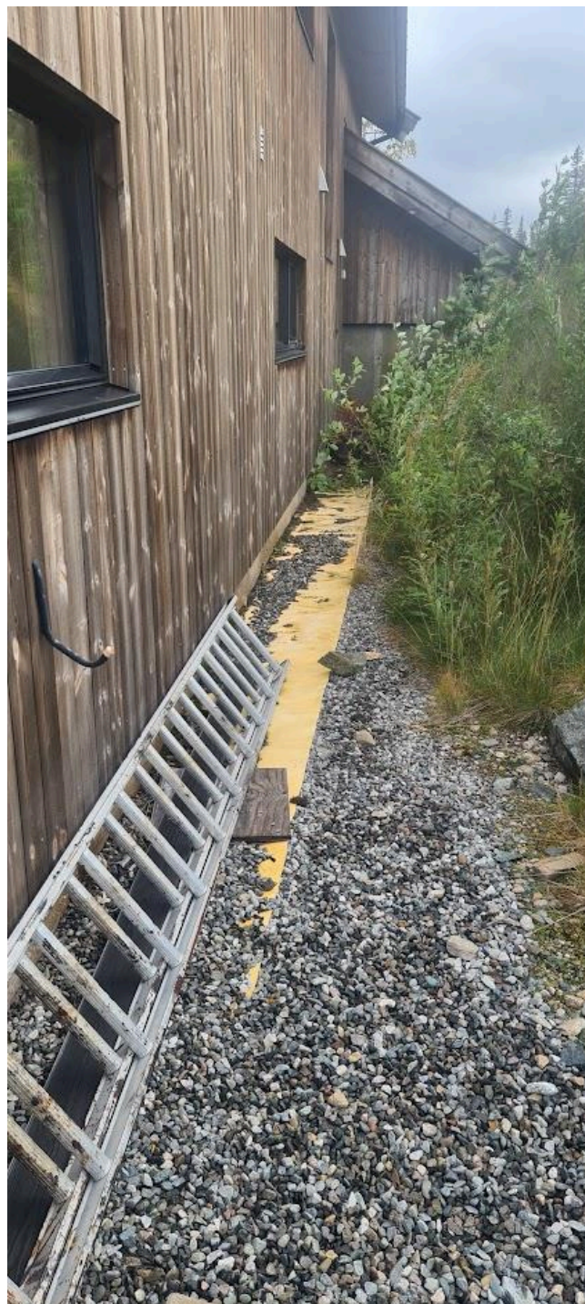
Terreng bak hytta hvor Radonduk mangler masse over radonduk.
