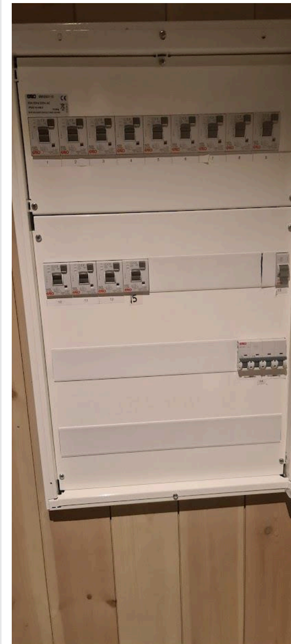
Sikringskap med jordfeil automatsikringer.
