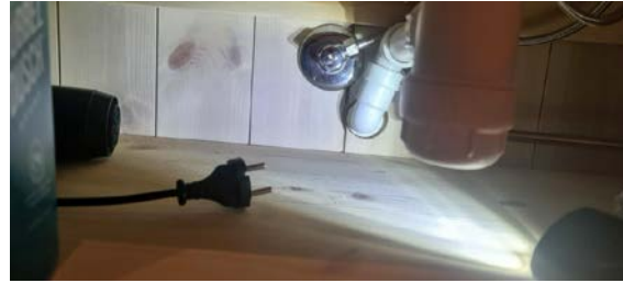
Avløpsrør under servant montert gjennom vegg uten membran, rør mansjett og elastisk fuge.
