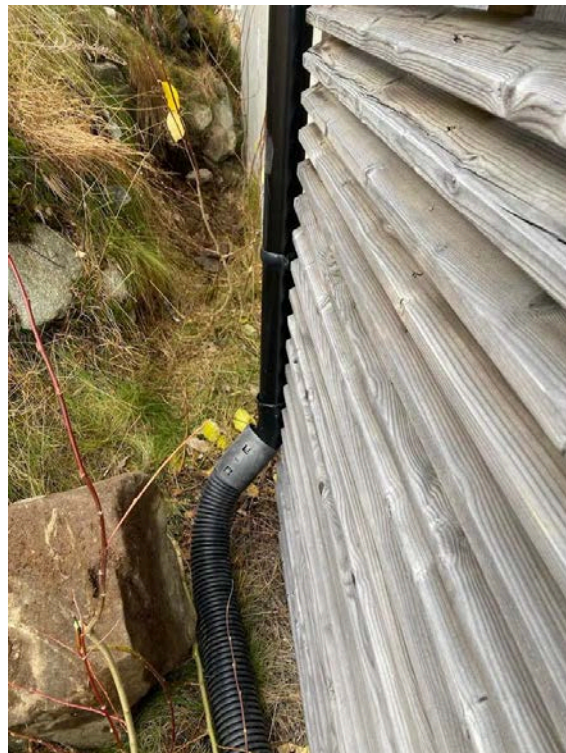
Eier sitt bilde tatt 24.10.24 hvor han montert avløpsledning fra baksiden av bod og ut i terrenget.
