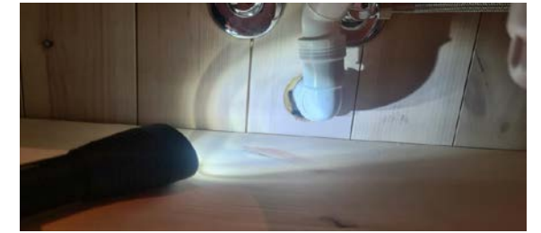
Bilde viser manglende membran, rørmansjett og elastisk fuge avløpsrør i våtsone ved servant.
