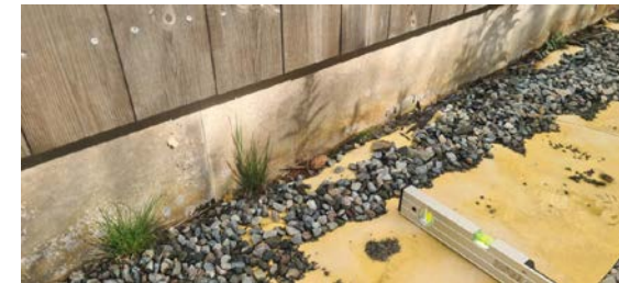
Bilde viser Radonduk montert under grunnmur uten overfylt masser. Radonduk har fall mot grunnmur. Antar drenering er etablert steinmasser under bygning. Fall mot grunnmur.
