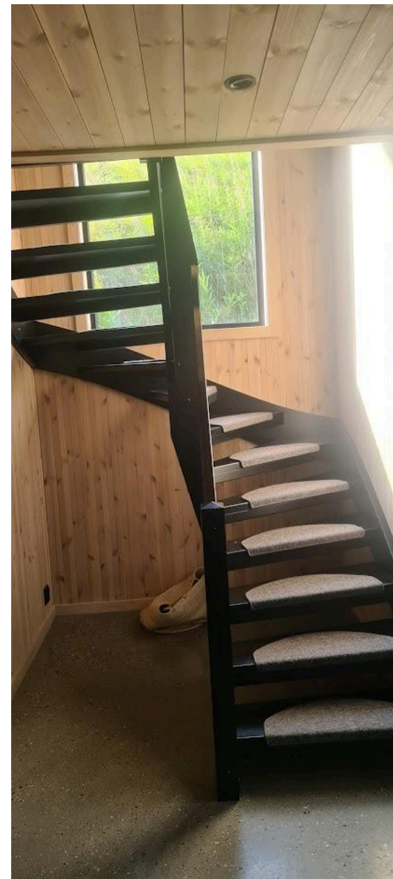
Åpen sort malt trapp til Loftetasje med selvklebende trappematter i trappetrinn, men uten håndløper på vegg
