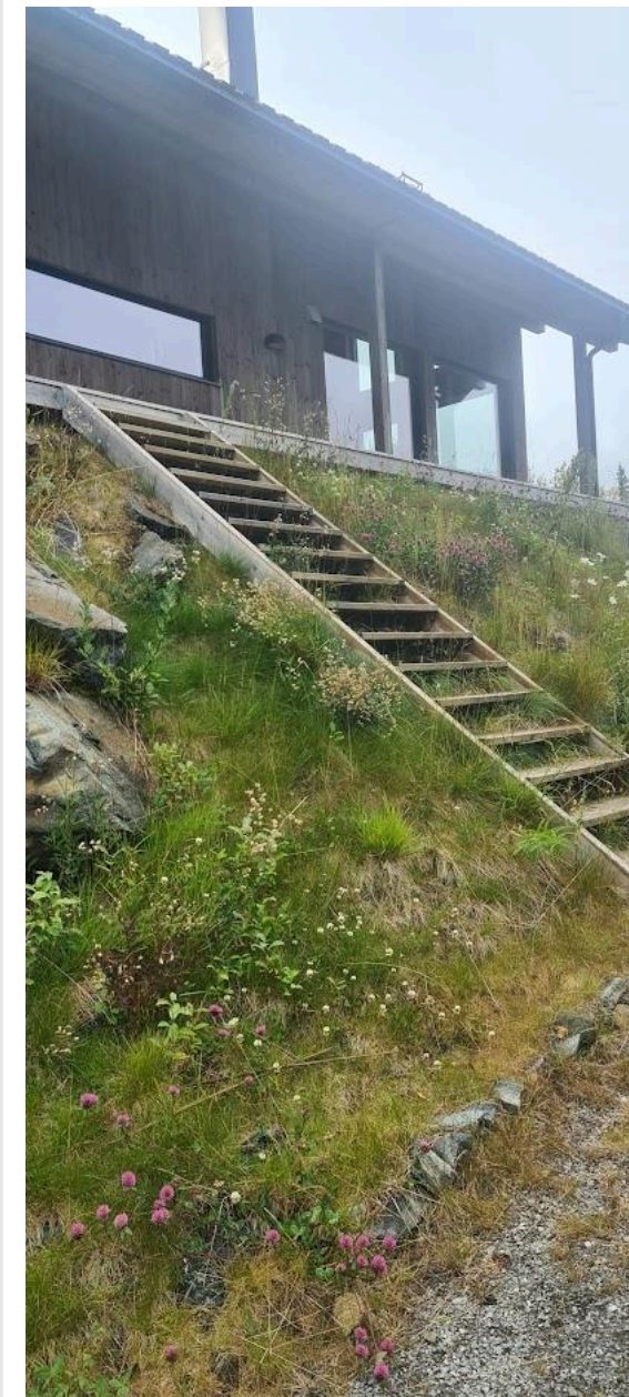
Terreng trapp uten rekkverk.
