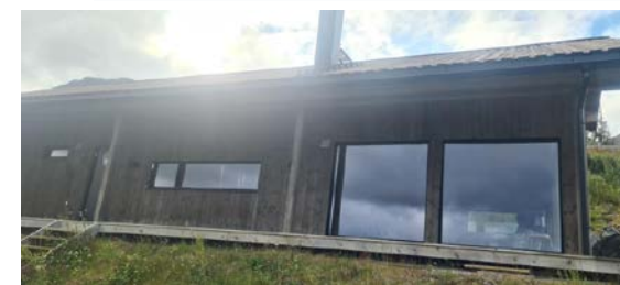
Tretak med beslått stålpipesom, takstige opp til pipe med feie-platå. Snøfangere mangler.
