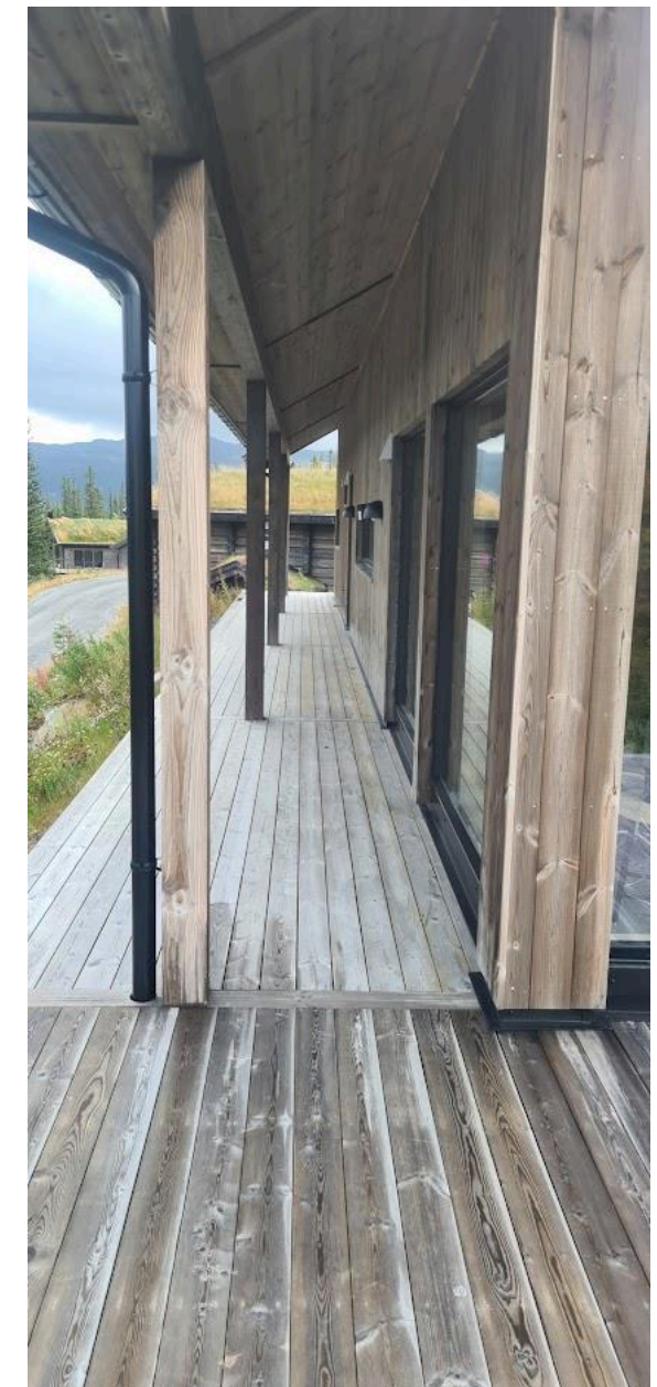
Overbygd terrasse å langvegg/hovedinngang. Terrasse mangler rekkverk.
