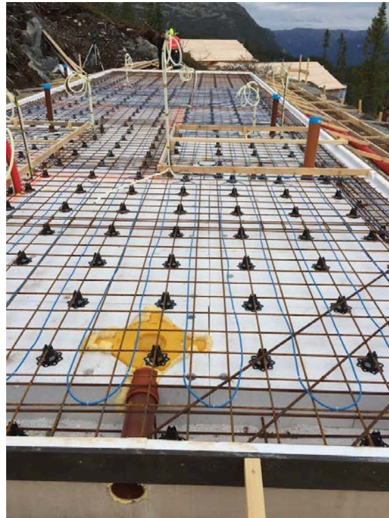
Bilde viser varmekabel i betonggulv i 1.etg.
