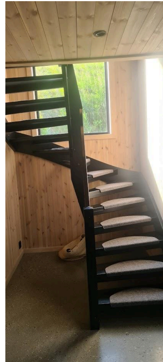
Åpen sort malt trapp til Loftetasje med selvklebende trappematter i trappetrinn, men uten håndløper på vegg
