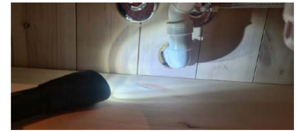
Bilde viser manglende membran, rørmansjett og elastik fuge avløpsrør i våtsone ved servant.
