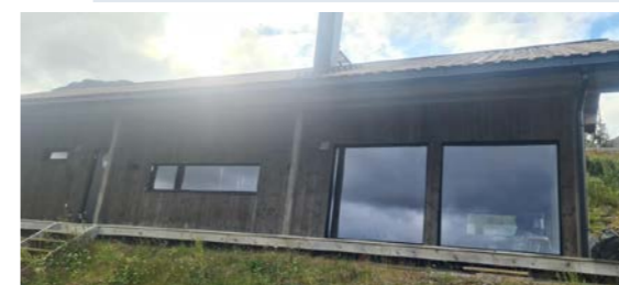
Tretak med beslått stålpipesom, takstige opp til pipe med feie-platå. Snøfangere mangler.
