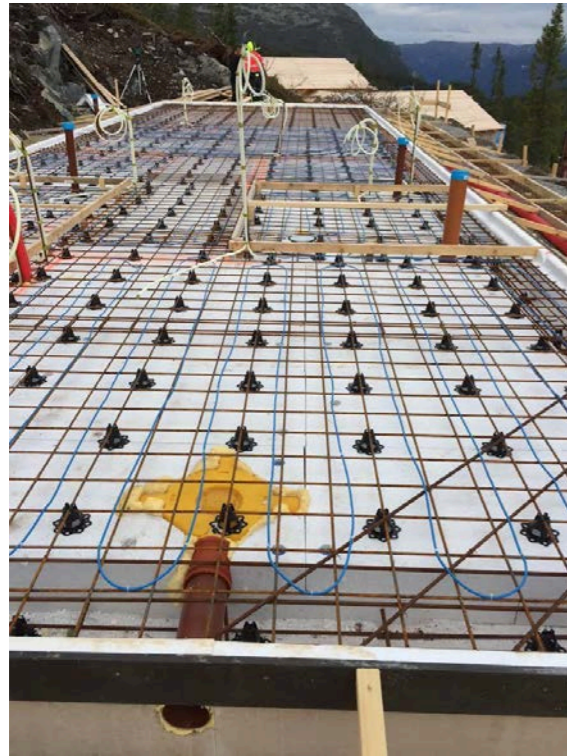
Bilde viser varmekabel i betonggulv i 1.etg.
