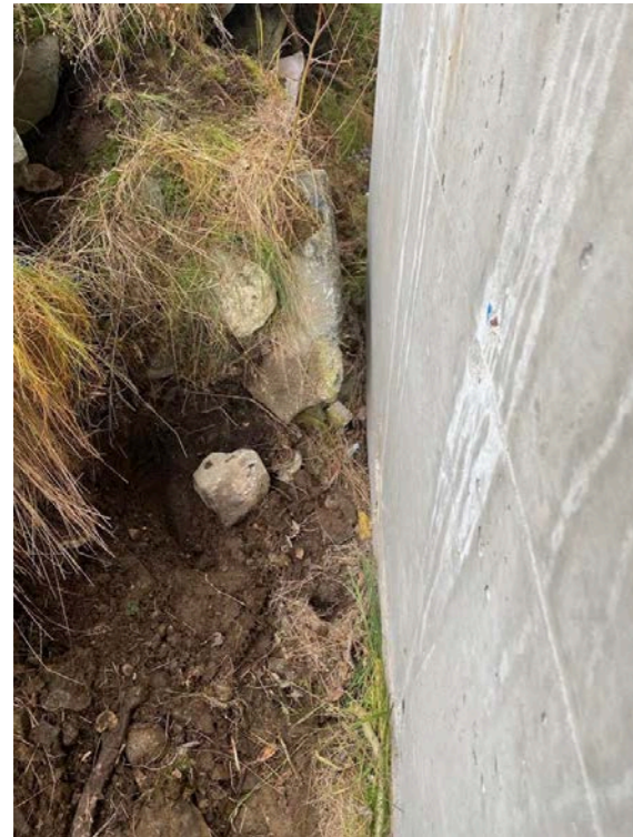
Eier sitt bilde tatt 24.10.24 viser steinblokk er fjernet fra betongvegg.
