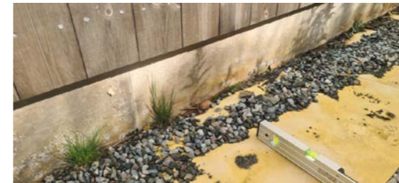
Bilde viser Radonduk montert under grunnmur uten overfylt masser. Radonduk har fall mot grunnmur. Antar drenering er etablert steinmasser under bygning. Fall mot grunnmur.
