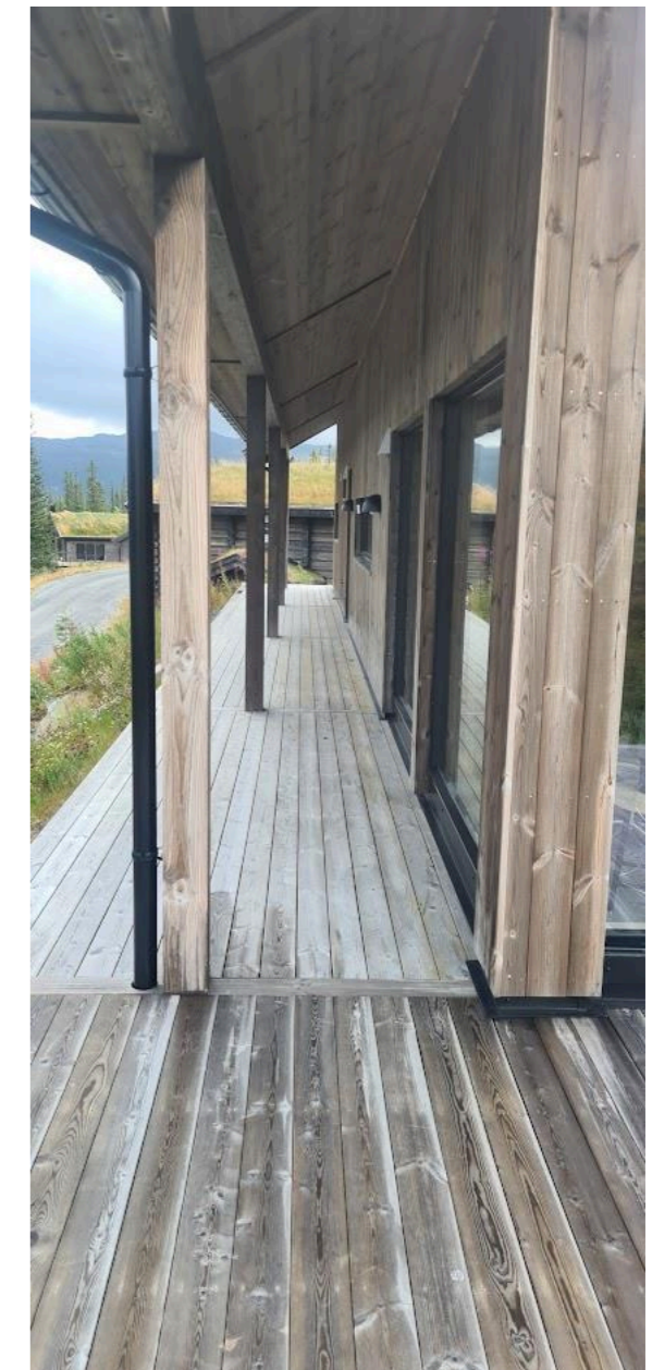
Overbygd terrasse å langvegg/hovedinngang. Terrasse mangler rekkverk.
