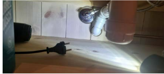
Avløpsrør under servant montert gjennom vegg uten membran, rør mansjett og elastisk fuge.
