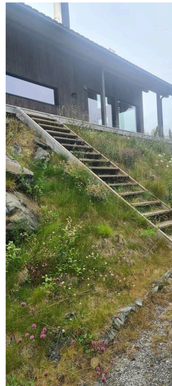
Terreng trapp uten rekkverk.
