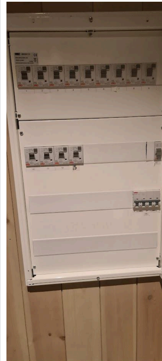
Sikringskap med jordfeil automatsikringer.
