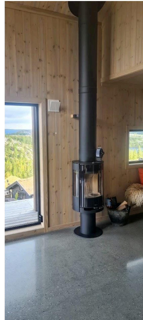
Aduro peisovn hvor Tolmer stålskorstein er montert ned på topp peisovn.
