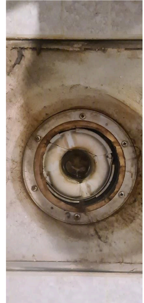
Synlig slukmansjett i sluk, men skade i sluk potte. Eier opplyser at sluk potte er byttet pr.24.10.24.
