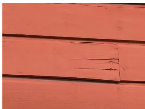
Sprekker og mulig fuktskade.
