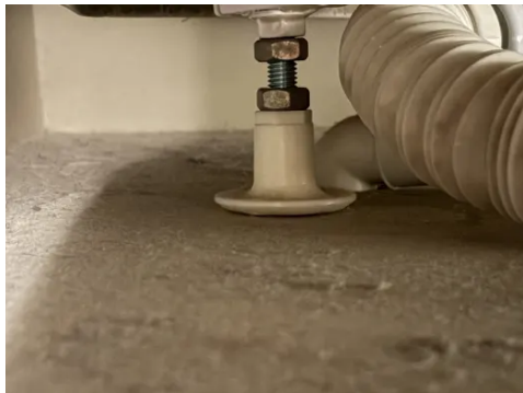
Egen avrenning fra dusjkabinett.
