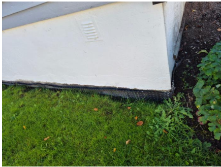
Manglende topplst og noe under terreng.
