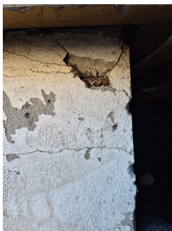
Sprekker og synlig armeringsjern i grunnmur.
