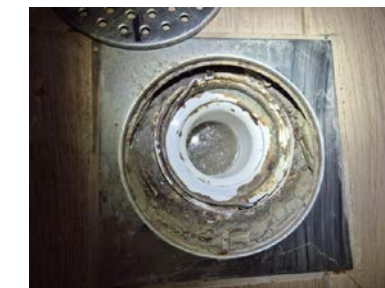
Sluk under kabinett.
