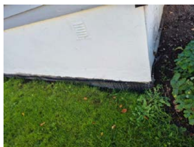
Manglende topplst og noe under terreng.
