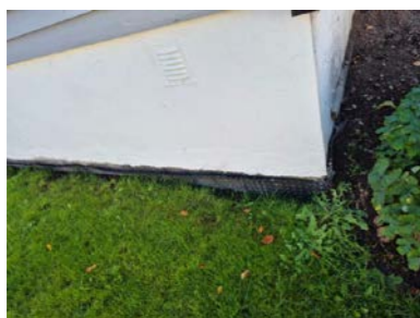
Manglende topplst og noe under terreng.
