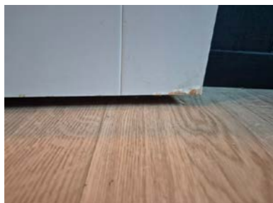
Fuktsvelling i bunn av dør.
