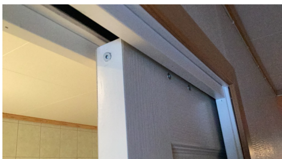
Plater har løsnet og er festet med skruer.
