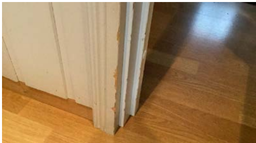
Eksempel på slitasje på karm.
