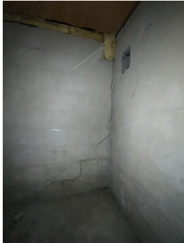
Synlige setningsskader på grunnmur.
