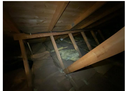
Montert durgventil på avløpsrør der kanal ut av takkonstruksjon bør opparbeides.
