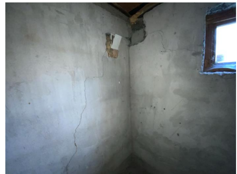
Synlige setningskader på grunnmur.
