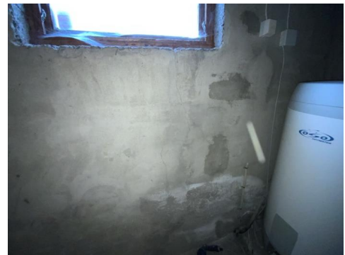
Synlige setningskader på grunnmur.
