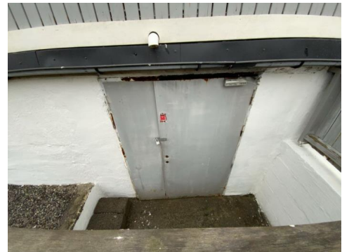
Synlige skader på dør der vedlikehold eller kommende utskiftninger er påregnelig på sikt.
