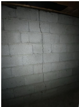
Setningskader på midtre bærende vegg i midt kjeller.
