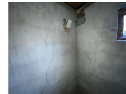
Synlige setningsskader på grunnmur.
