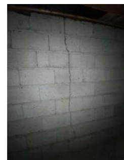
Setningskader på midtre bærende vegg i midt kjeller.
