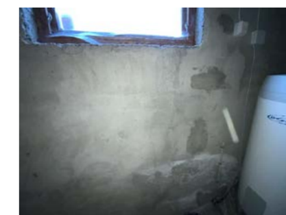
Synlige setningsskader på grunnmur.
