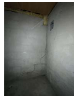
Synlige setningsskader på grunnmur.
