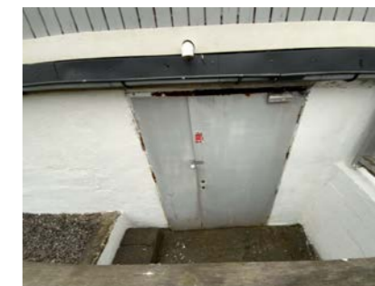
Synlige skader på dør der vedlikehold eller kommende utskiftinger er påregnelig på sikt.
