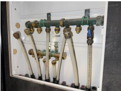
Åpne hull på hver side av rørskap.
