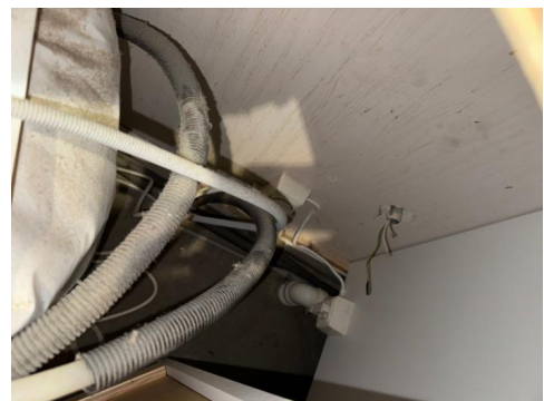
VV-bereder via skjult stikk (utilgjengelig)
