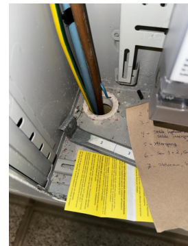
Utett rørgjennomføring i el-skap
