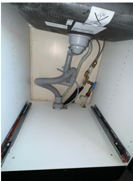
Ingen tettemuffer i enden av varerør i kjøkkenbenk.
