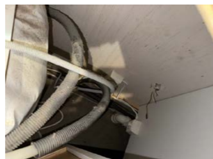
VV-bereder via skjult stikk (utilgjengelig)
