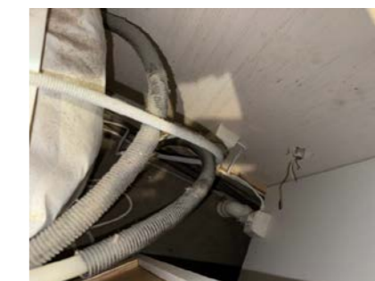
Utilgjengelige stikkontakter og uisolerte løse ledninger
