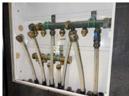
Åpne hull på hver side av rørskap.
