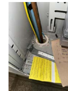
Utett rørgjennomføring i el-skap
