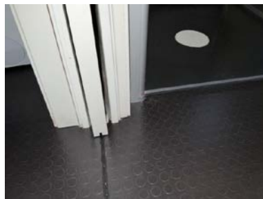
Ukjent løsning ved døren, forsiktighet ved bruk anbefales.
