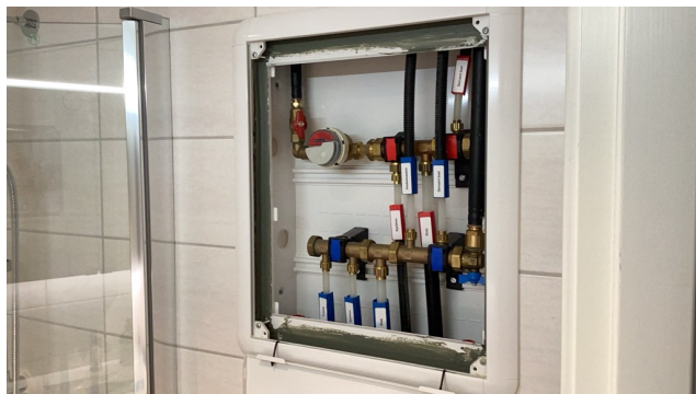
2 stoppekraner i skap
