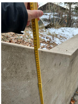
Rekkverk langs trapp er målt til 78cm.
