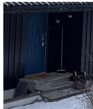
Trapp utenfor inngangspartiet mangler rekkverk.
