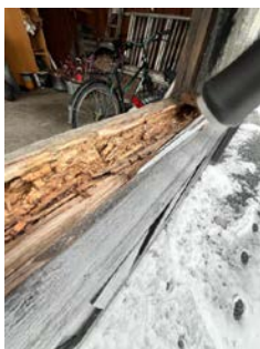
Råteskade på et lite område av vegg mot vest på carport.
