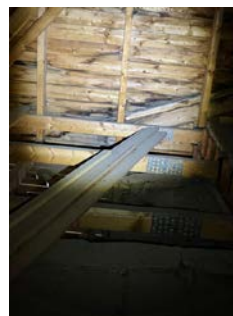
Fuktskader på trepanel på gavlvegg på bolig mot carport.
