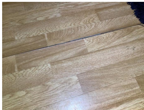
Bildet viser løs gulvbeleggsjøt.
