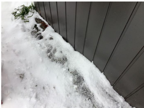
Bildet viser at deler av veggkonstruksjonen er ført nært terreng.
