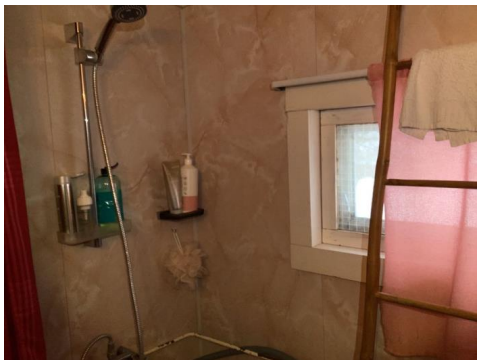
Bildet viser at vindu er plassert i den definerte våtsonen.
