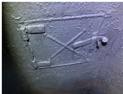
Bildet viser at sotluke er overmalt, og denne lot seg ikke åpne.
