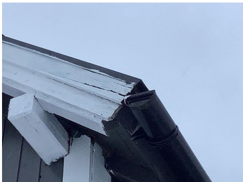
Bildet viser råteskadet vindski.
