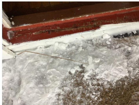
Bildet viser sprukket dørterskel.
