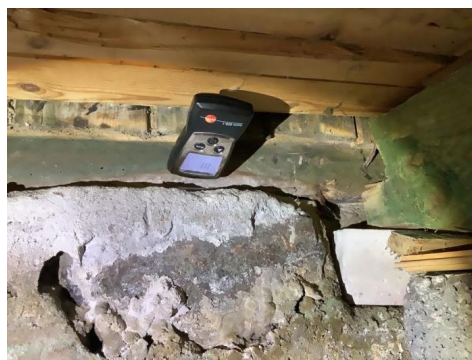
Bildet viser fuktmåling og at det måles over 28 vektprosent fuktinnhold i bærebjelke.
