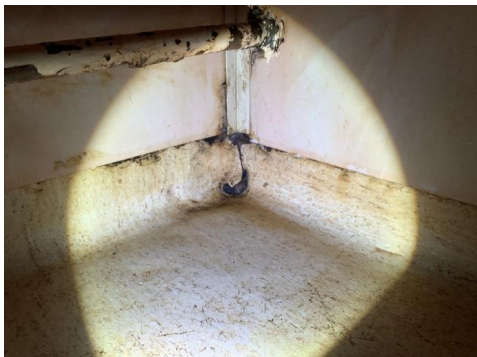
Bildet viser utett sveis i gulvbelegg.
