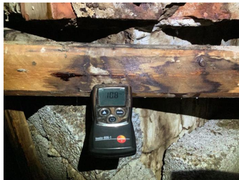
Bildet viser misfarget treverk ved pipe, og at det måles tørt.
