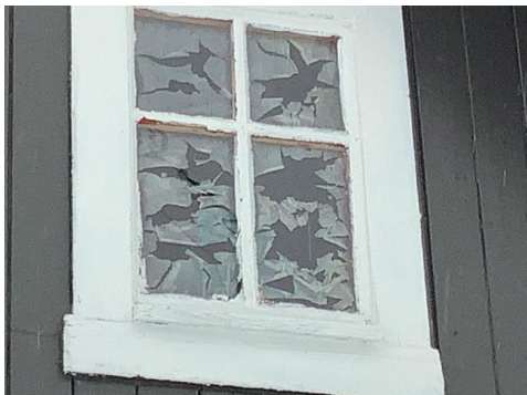
Bildet viser at vindu som er kledd inn fra innsiden har sprukket glass.
