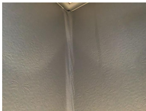
Bildet viser eksempel på at tapet bølgjer seg i hjørner.
