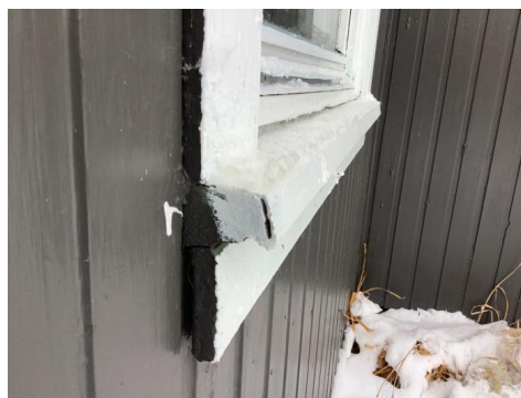
Bildet viser feil fallforhold på vannbrett.
