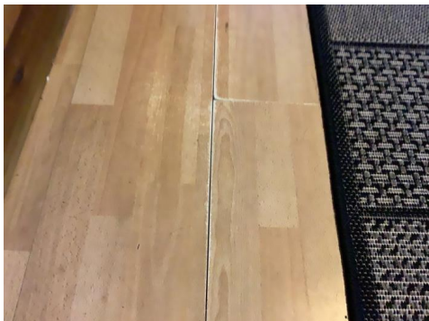
Bildet viser slipp i langsgående laminatskjøt.
