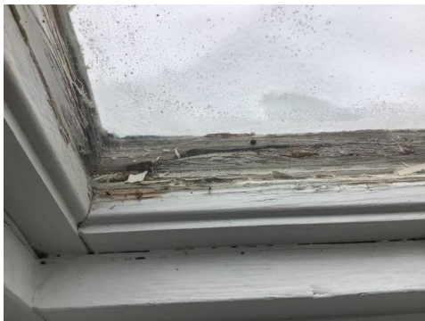
Bildet viser misfarget treverk mellom koblede glass.
