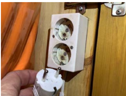
Bildet viser tegn til varmgang på stikkontakt.
