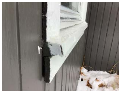
Bildet viser feil fallforhold på vannbrett.
