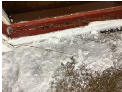
Bildet viser sprukket dørterskel.
