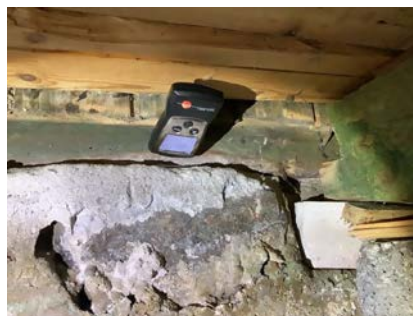
Bildet viser fuktmåling og at det måles over 28 vektprosent fuktinnhold i bærebjelke.
