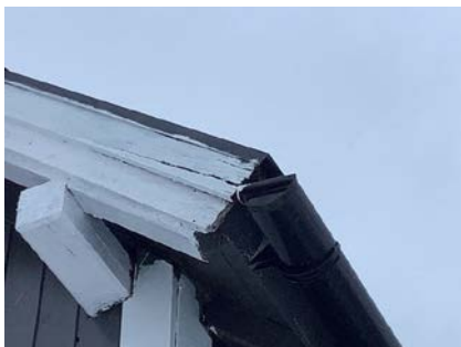
Bildet viser råteskadet vindski.
