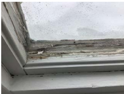
Bildet viser misfarget treverk mellom koblede glass.
