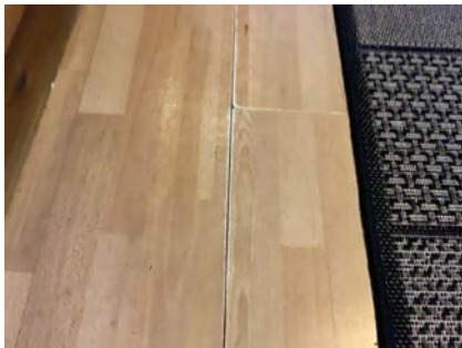
Bildet viser slipp i langsgående laminatskjøt.
