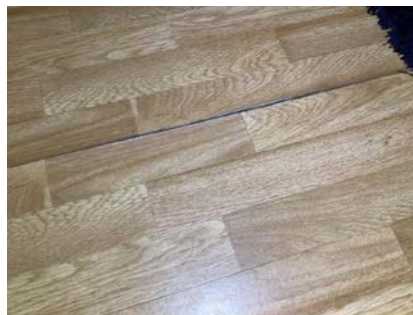
Bildet viser løs gulvbeleggskjøt.
