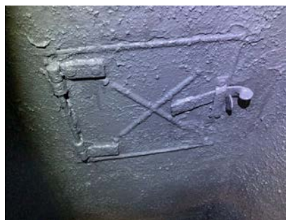
Bildet viser at sotluke er overmalt, og denne lot seg ikke åpne.
