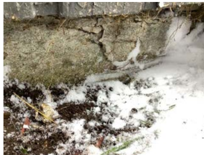
Bildet viser skråriss i ringmuren.
