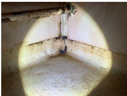
Bildet viser utett sveis i gulvbelegg.
