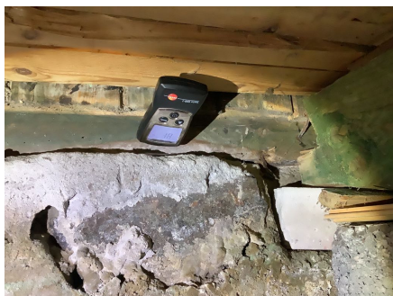
Bildet viser fuktmåling og at det måles over 28 vektprosent fuktinnhold i bærebjelke.
