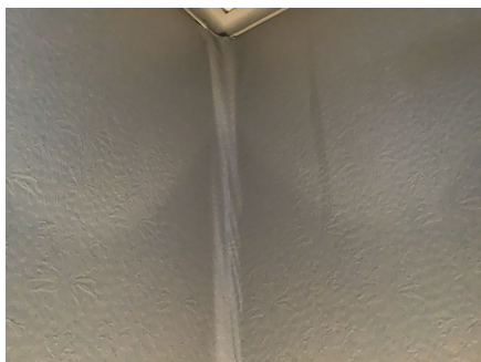
Bildet viser eksempel på at tapet bølgjer seg i hjørner.
