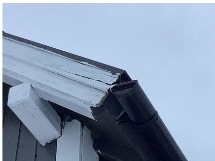
Bildet viser råteskadet vindski.
