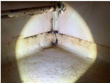
Bildet viser utett sveis i gulvbelegg.
