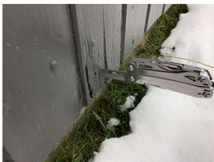
Bildet viser eksempel på spredte råteskader i bordkledningen.
