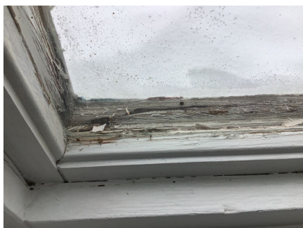
Bildet viser misfarget treverk mellom koblede glass.
