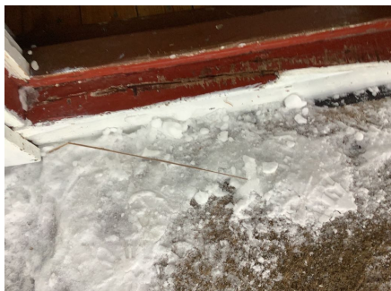
Bildet viser sprukket dørterskel.
