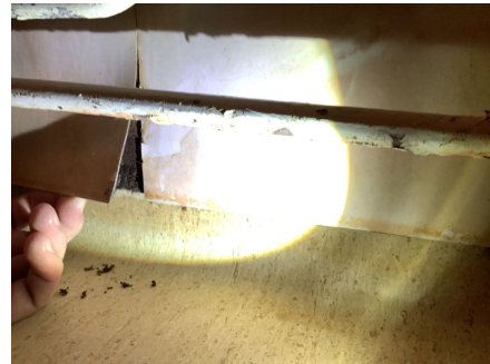
Bildet viser fuktskadet baderomsplate i dusjsonen.
