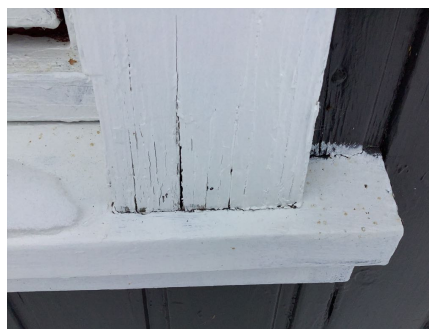
Bildet viser at omrømming er ført helt til vannbrett, og dette har ført til oppsprekking.
