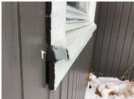
Bildet viser feil fallforhold på vannbrett.
