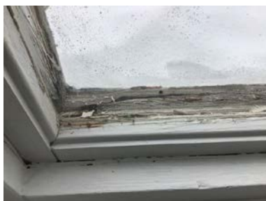
Bildet viser misfarget treverk mellom koblede glass.
