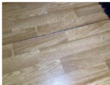
Bildet viser løs gulvbeleggskjøt.
