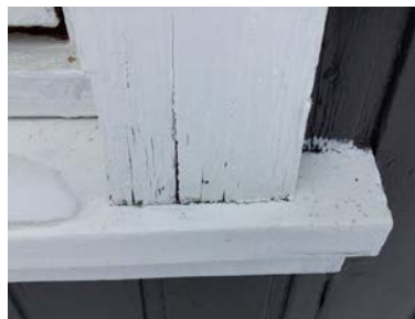
Bildet viser at omramming er ført helt til vannbrett, og dette har ført til oppsprekking.
