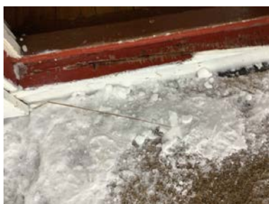
Bildet viser sprukket dørterskel.
