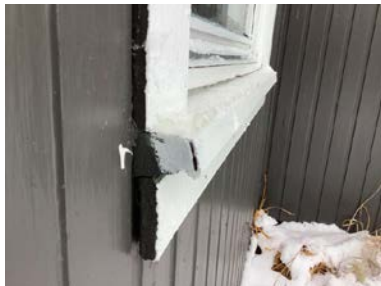
Bildet viser feil fallforhold på vannbrett.
