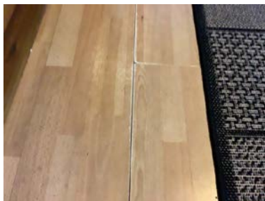
Bildet viser slipp i langsgående laminatskjøt.
