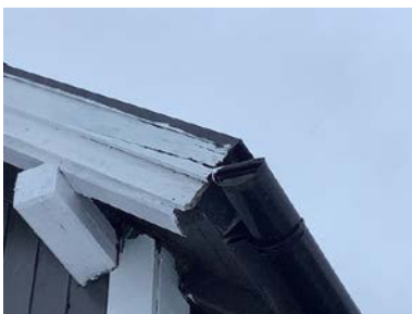
Bildet viser råteskadet vindski.
