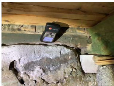
Bildet viser fuktmåling og at det måles over 28 vektprosent fukttinnhold i bærebjelke.
