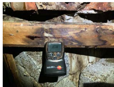
Bildet viser misfarget treverk ved pipe, og at det måles tørt.
