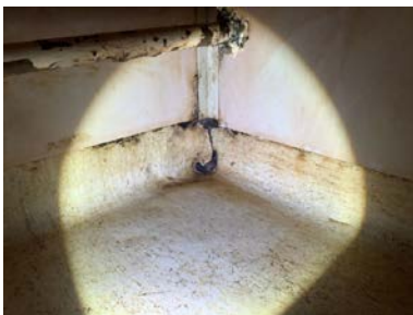
Bildet viser utett sveis i gulvbelegg.
