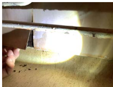
Bildet viser fuktskadet baderomsplate i dusjsonen.
