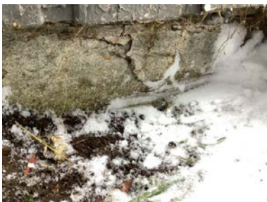
Bildet viser skråriss i ringmuren.
