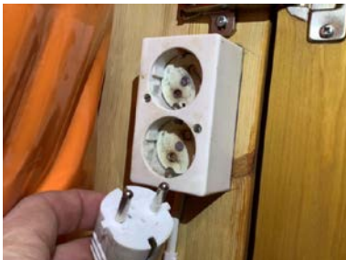
Bildet viser tegn til varmgang på stikkontakt.
