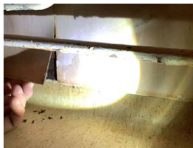
Bildet viser fuktskadet baderomsplate i dusjsonen.
