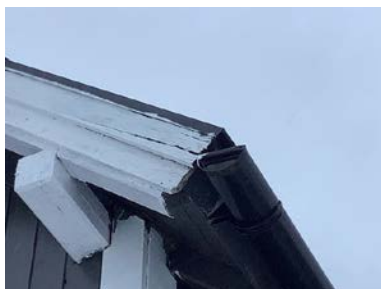
Bildet viser råteskadet vindski.
