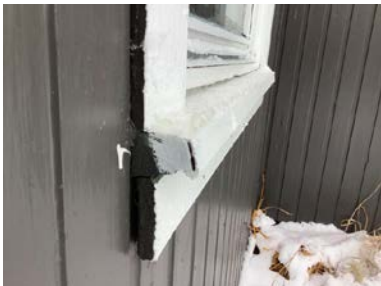
Bildet viser feil fallforhold på vannbrett.
