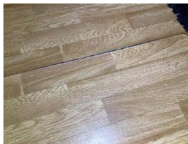
Bildet viser løs gulvbeleggskjøt.
