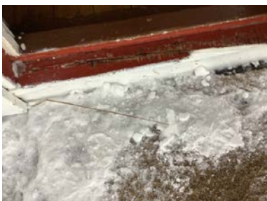
Bildet viser sprukket dørterskel.
