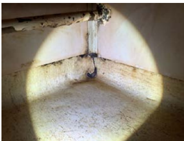
Bildet viser utett sveis i gulvbelegg.
