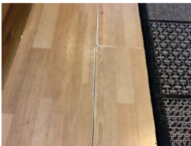
Bildet viser slipp i langsgående laminatskjøt.
