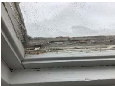
Bildet viser misfarget treverk mellom koblede glass.
