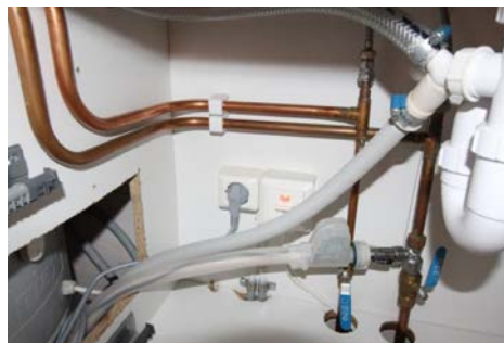
Vannledninger i kjøkkenbenk.
