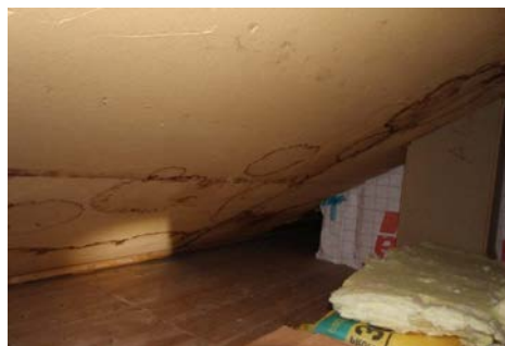
Fuktmerker i kledning under taksperreer.
